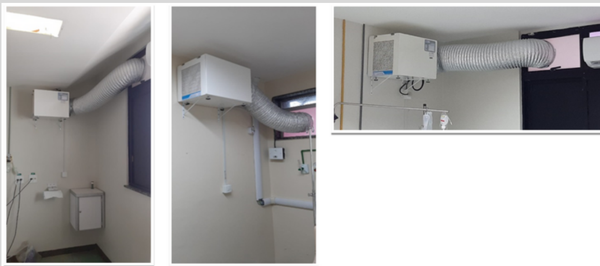
Figuras 25, 26 e 27 - Sistema de exaustão instalado no Anexo C
