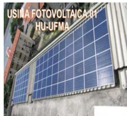
Painel Solar de geração de energia
