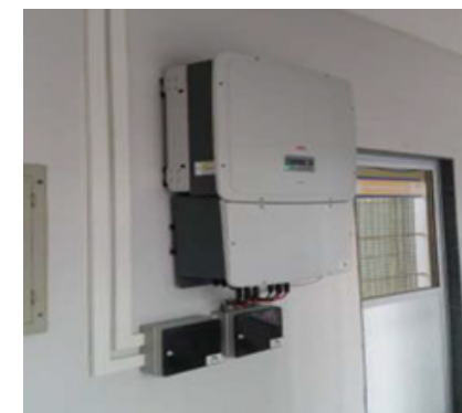
Equipamento Inversor de frequência que absorve e faz a conversão da energia contínua captada pelos painéis solares em energia elétrica alternada utilizada no sistema predial.
