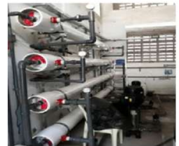
Figura 25. Modernização do Sistema de Dessalinização da água utilizada nas instalações do HU-UFMA
