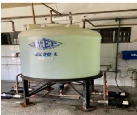
Figura 16. Modernização do novo sistema de osmose reversa
