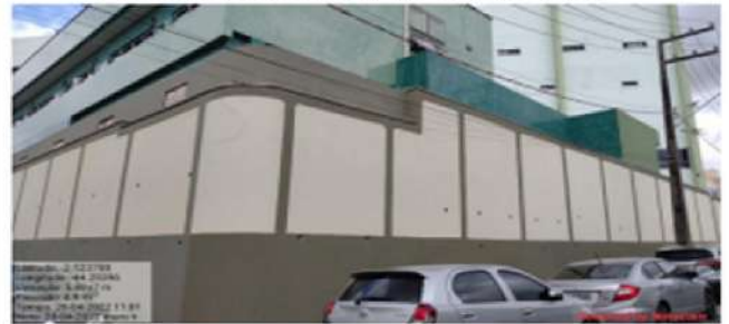
Figura 22. Obra de reforço estrutural do muro e das fundações do Bloco G da Unidade Presidente Dutra. R$ 342.643,17
