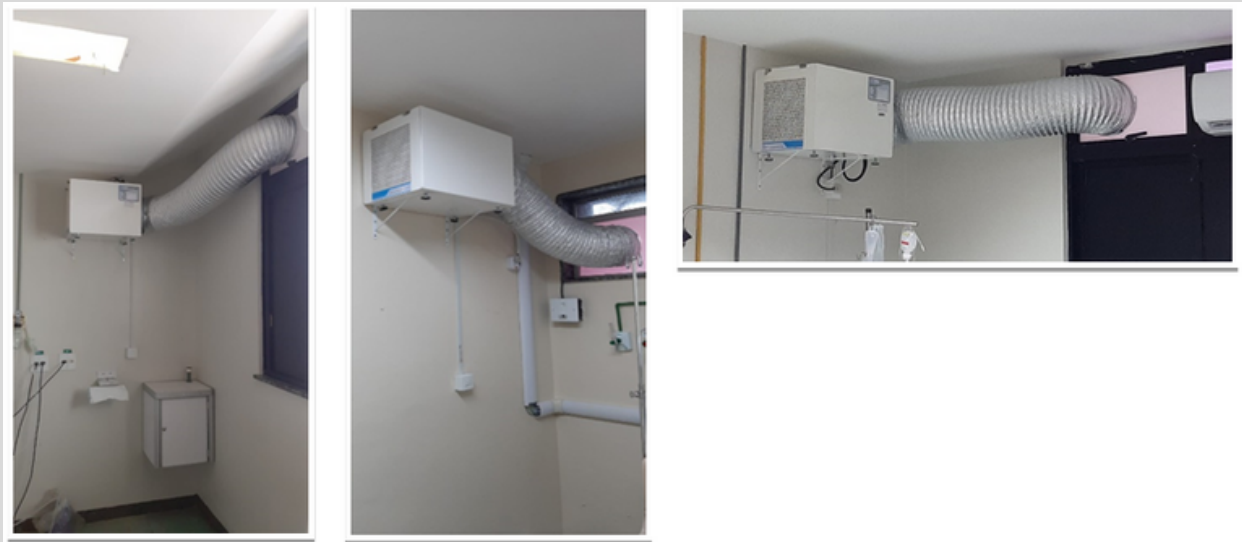
Figuras 25, 26 e 27 - Sistema de exaustão instalado no Anexo C
