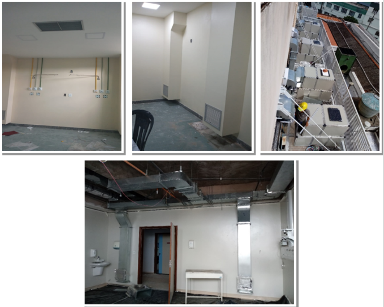
Figuras 28, 29, 30 e 31 - Sistema de exaustão instalado no Anexo C
