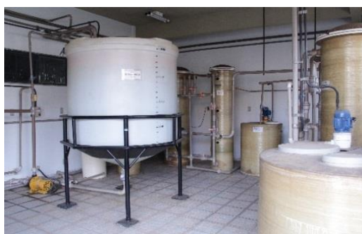
Fig.12 Estação de Tratamento de Água
