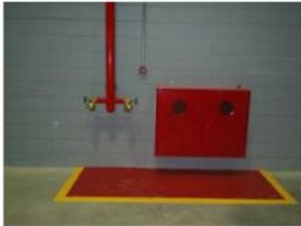
Fig. Sistema de hidrantes
