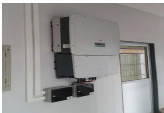
Figura 14 - Equipamento Inversor de frequência que absorve e faz a conversão da energia contínua captada pelos painéis solares em energia elétrica alternada utilizada no sistema predial.
