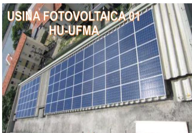
Figura 13 – Painel Solar de geração de energia
