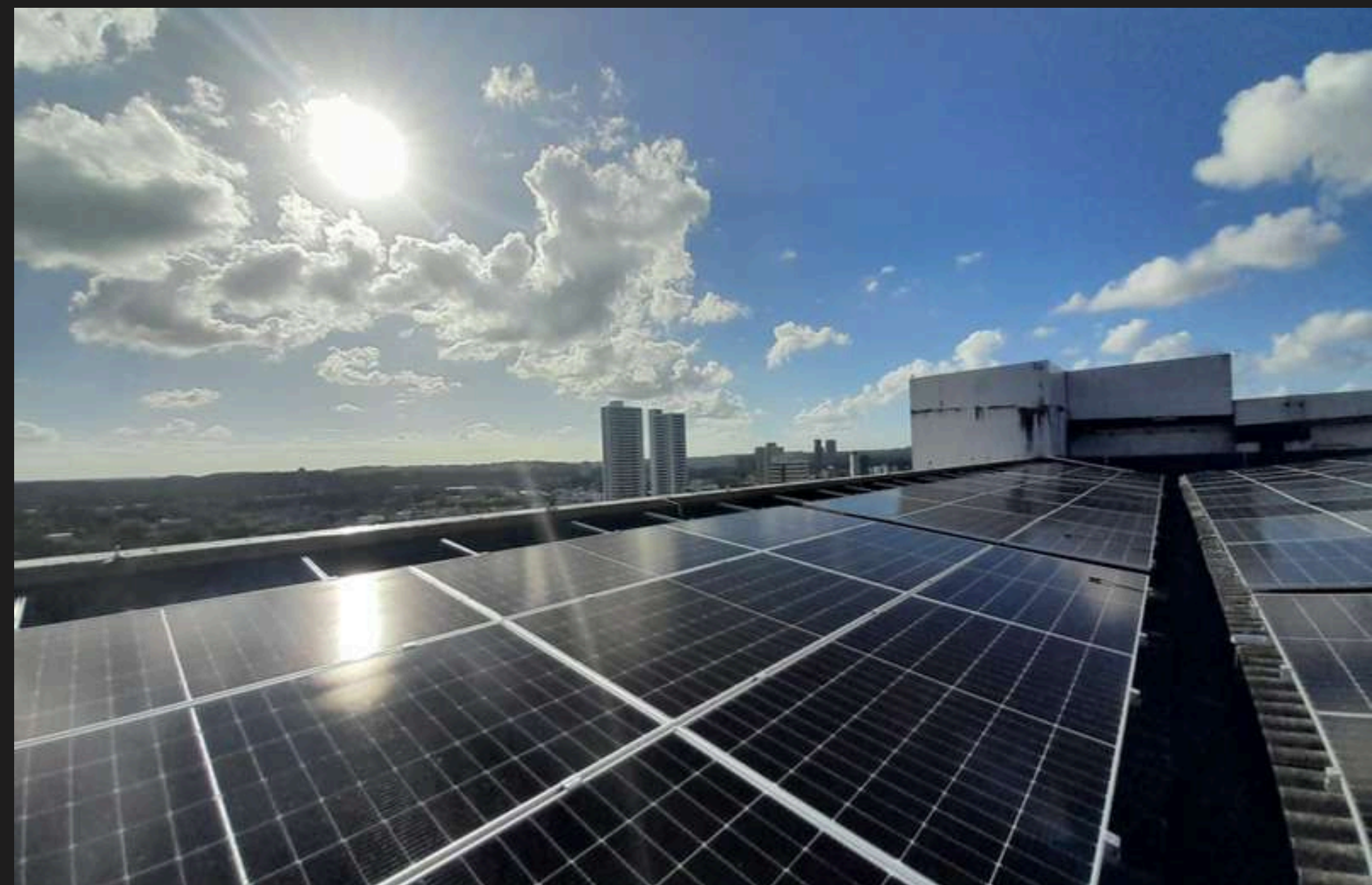
usina fotovoltaica do HC
