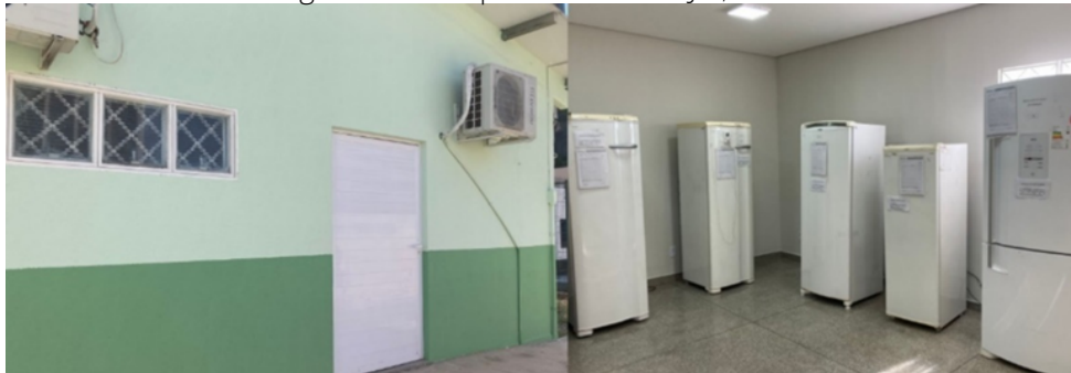
Figura 5. Biorrepositório do HUJM, 2022/1
