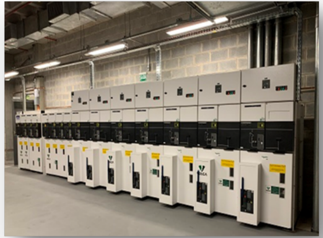
Figura 7. Subestação de Energia Elétrica
