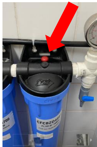
Figura 4 – Válvula de escoamento do ar dos filtros externos.
