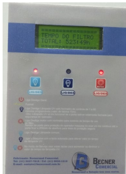
Figura 1 – Acionamento da luz fluorescente da CSB
