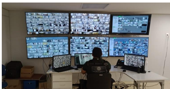
Figura 15 – Central de Monitoramento – Unidade de Serviços Gerais
