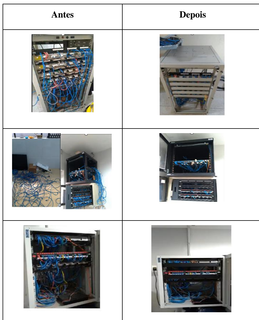
Figura 30 – Organização dos Cabeamentos dos Racks
