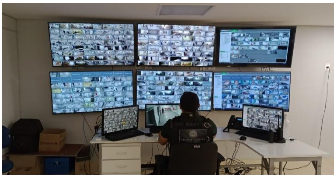
Figura 13 – Central de Monitoramento – Unidade de Serviços Gerais
