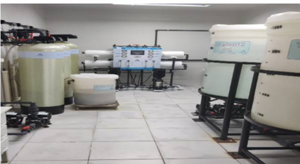
Figura 15. Tratamento de Água da Hemodiálise
