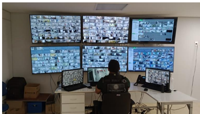
Central de monitoramento – Unidade de Serviços Gerais
