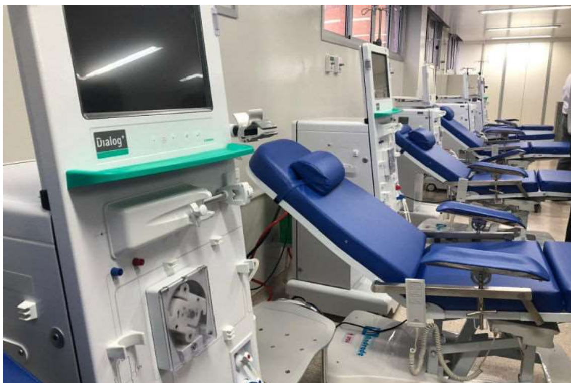
Figura 2 - Equipamentos da Hemodiálise já instalados na obra
