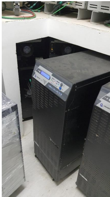
Nobreak e estabilizador de tensão no HUAB-UFRN.
