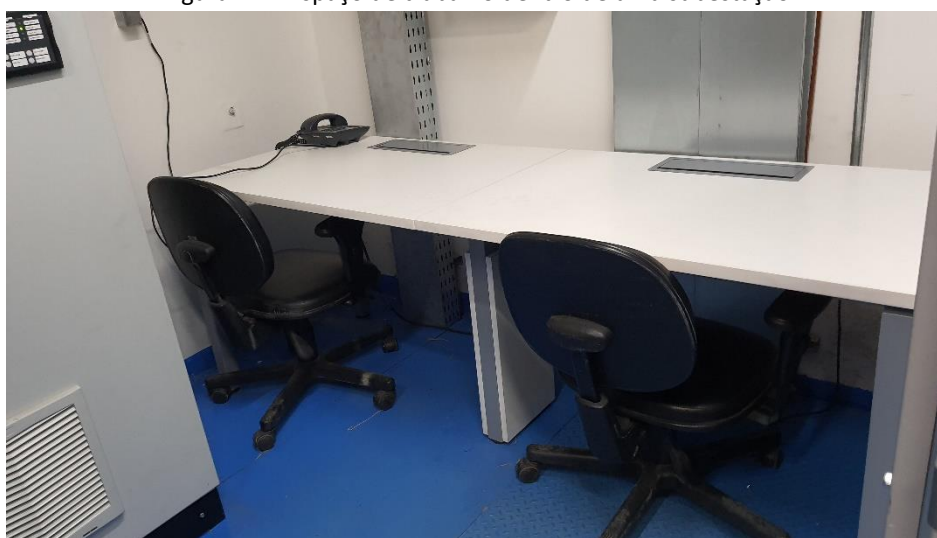
Figura 24 – Espaço de trabalho dentro de uma subestação
