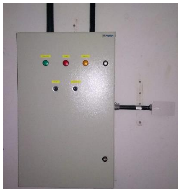
Painel elétrico para climatização
