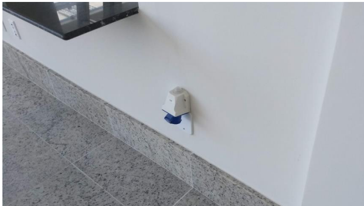
Figura 10 – Exemplo de aplicação e instalação das tomadas tipo industrial
