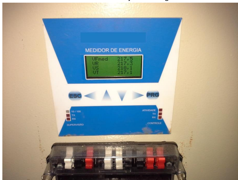
Multimetedor instalado em uma subestação da Escola de Ciências e Tecnologia da Universidade Federal do Rio Grande do Norte (UFRN).
