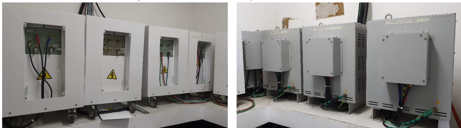
Figura 2 – Transformadores de isolação do sistema IT médico
