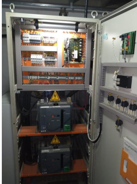
Figura 21 – Painel elétrico contendo as chaves intertravadas
