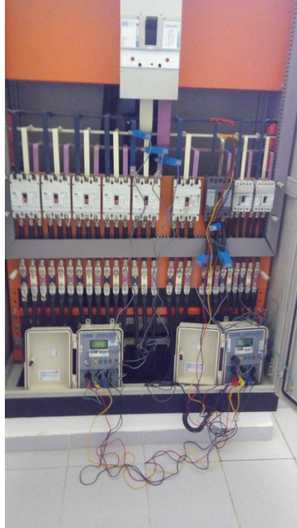
Figura 27 – Exemplo de multimetedor local das grandezas elétricas
