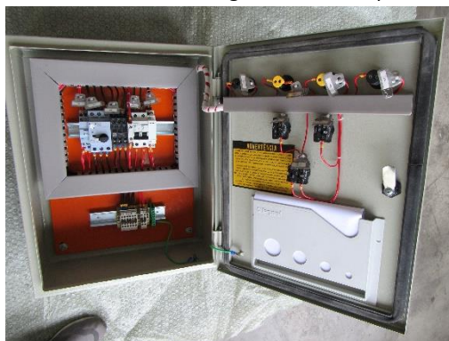
Painel elétrico do HC-UFG
