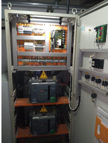
Painel elétrico contendo as chaves intertravadas, sendo uma chave ligada ao grupo motor gerador principal e outra para by-pass
