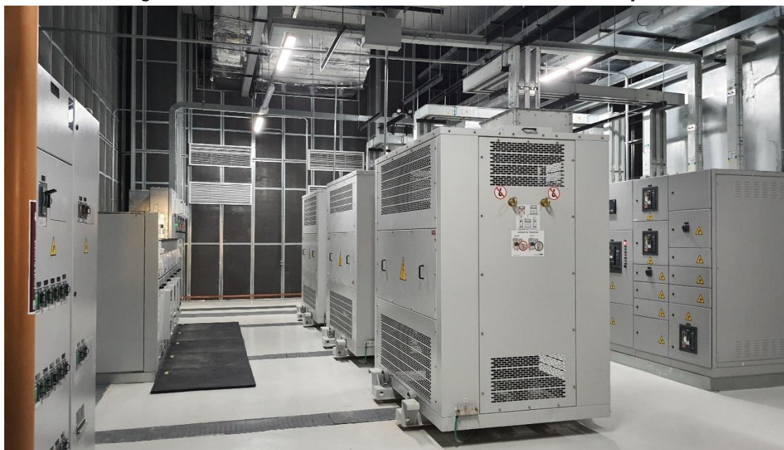
Subestação de energia elétrica do Hospital Israelita Albert Einstein
