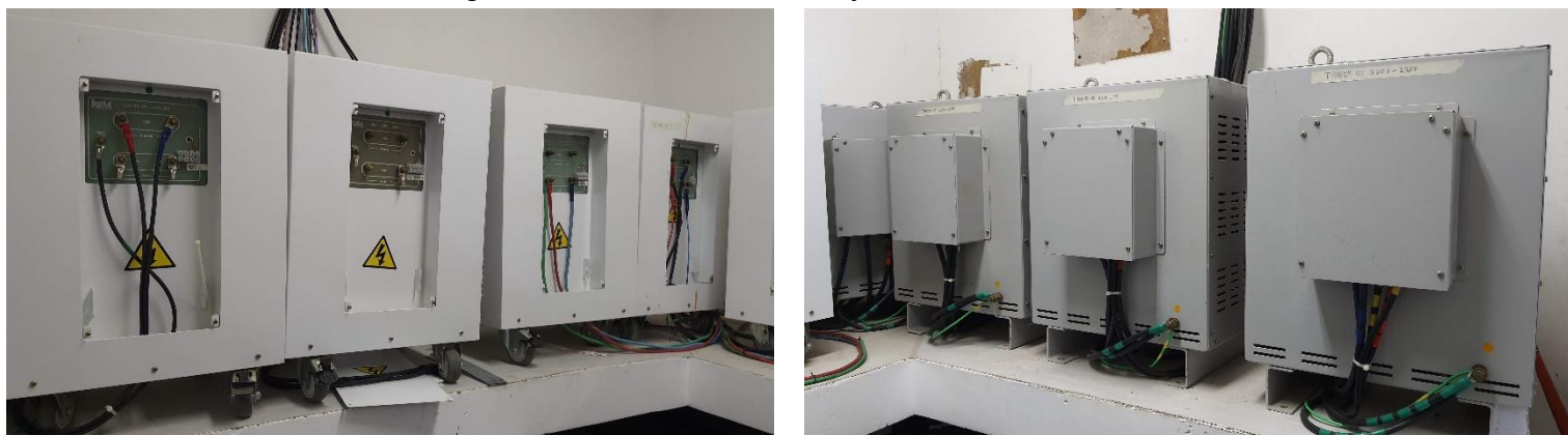
Figura 2 – Transformadores de isolação do sistema IT médico
