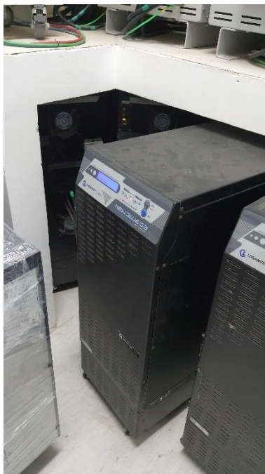
Nobreak e estabilizador de tensão no HUAB-UFRN.
