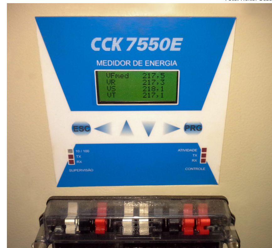
Figura 37 – Exemplo de Utilização de Medidor Geral das Grandezas Elétricas, Instalado na Subestação de Energia Elétrica da Escola de Ciências e Tecnologia, na Universidade Federal do Rio Grande do Norte
