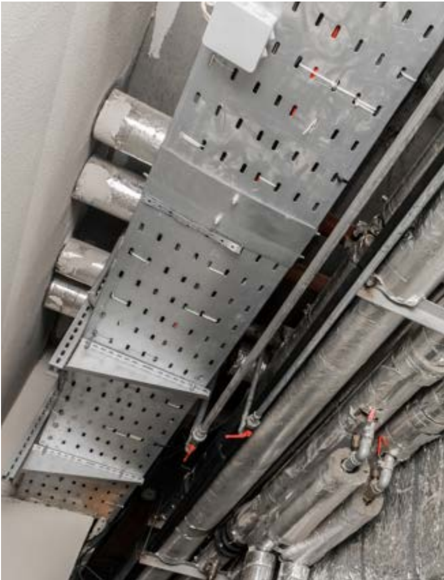
Figura 121 – Cabos Fixados em Eletrocalha
