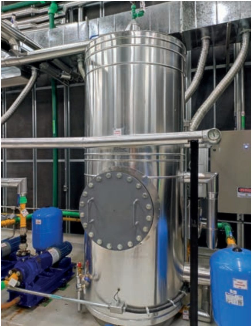
Figura 80 – Central de Água Quente e Bombas de Recirculação
