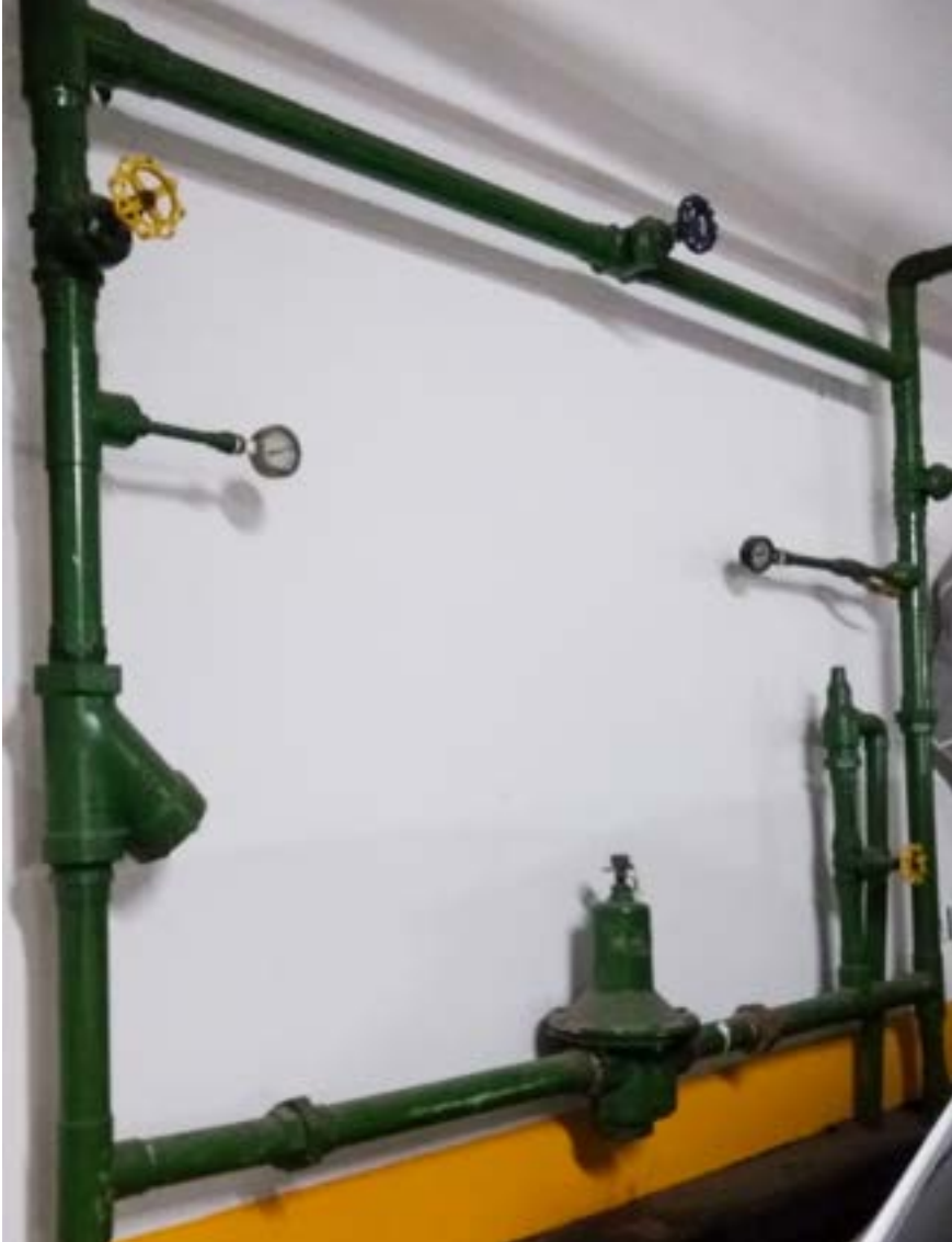
Figura 78 – Estação Redutora de Pressão
