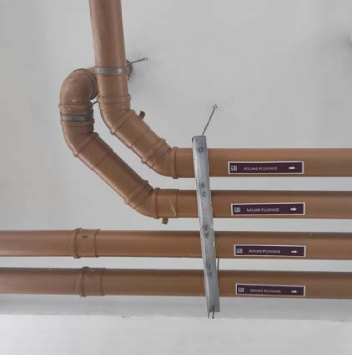
Figura 87 – Prumadas de Águas Pluviais Instaladas Junto ao Teto
