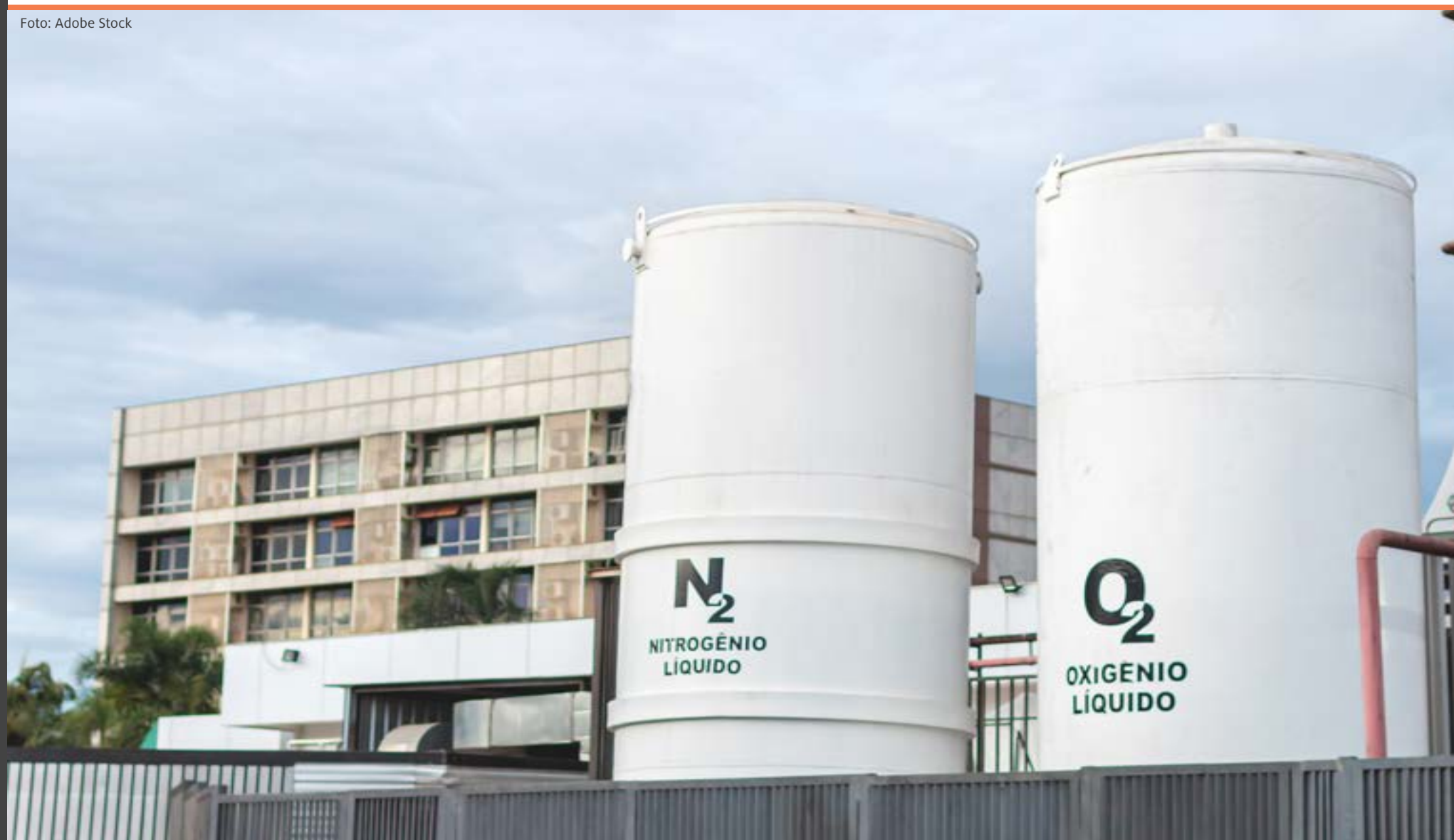
Figura 93 – Tanque de Nitrogênio e Oxigênio na Parte Exterior de um Hospital
