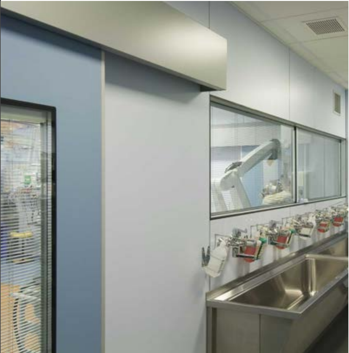
Figura 45 – Persiana Insulada Instalada em Sala Cirúrgica
