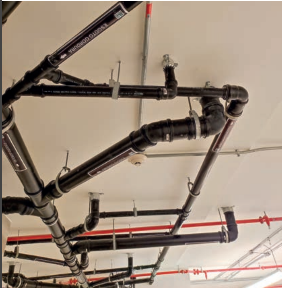
Figura 84 – Rede de Esgoto de Gordura junto ao Teto
