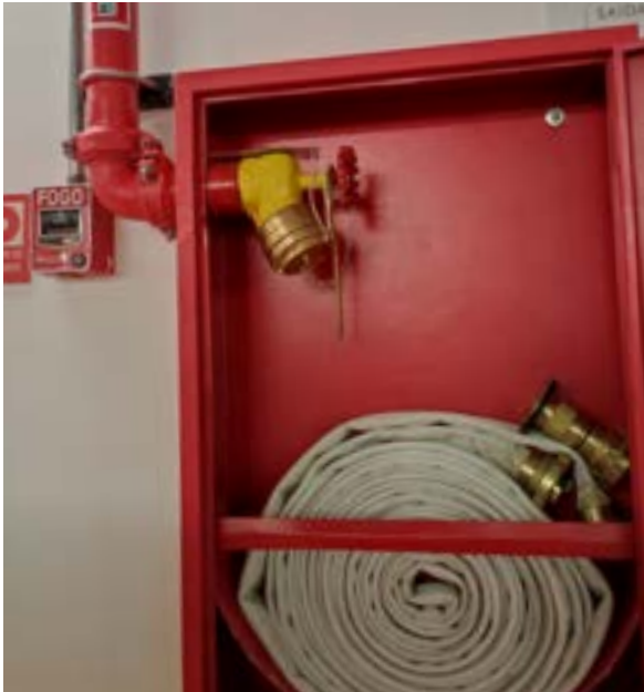
Figura 107 – Sistema de Alarme com Acionador Manual Instalado Junto ao Hidrante
