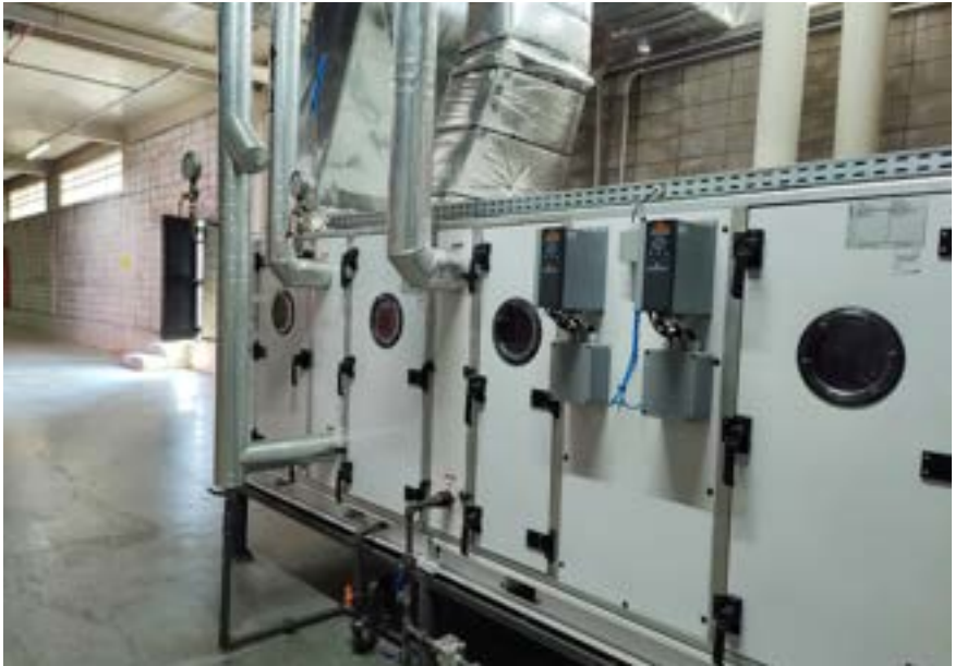
Figuras 143 e 144 – Fan coil /UTA em Piso Técnico Acima do Centro Cirúrgico com/Rede Hidráulica de Água Gelada Isolada Termicamente e Rede de Dutos de Ar Termicamente Isolados Também
