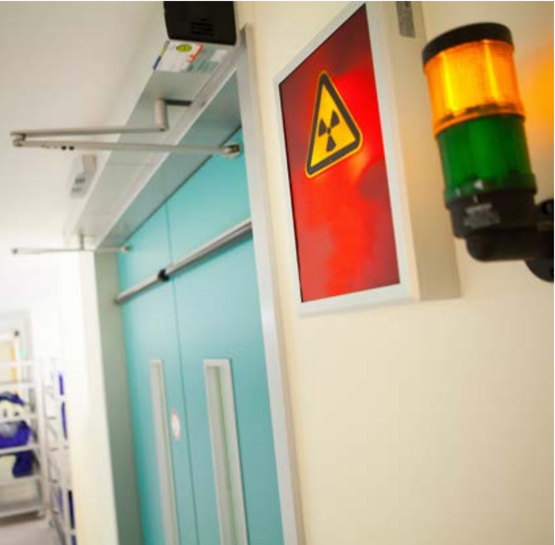
Figura 51 – Porta com Sinalização Luminosa e Comunicação Visual Instalada em Sala de Tratamento
