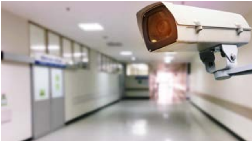
Figura 131 – Câmeras Instaladas na Circulação
