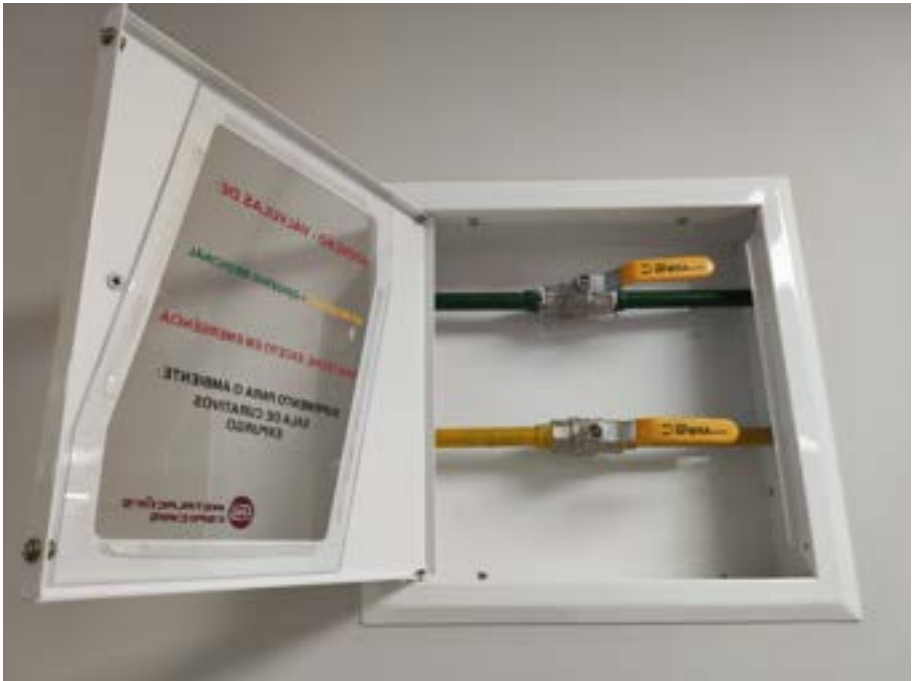
Figura 94 – Caixa Seccionadora do Andar
