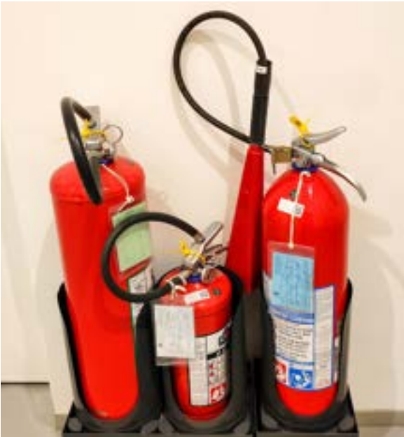
Figura 108 – Extintores Instalados no Piso
