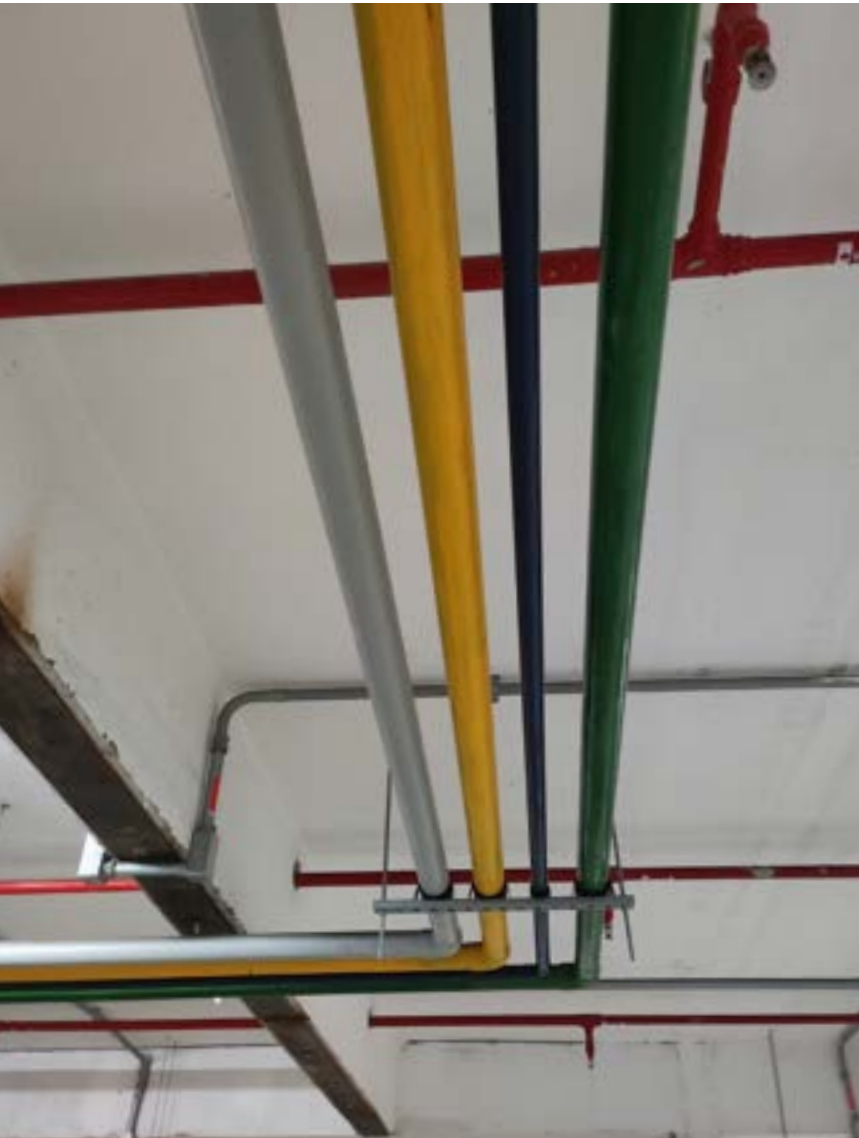
Figura 96 – Tubulações de Gases Medicinais e Vácuo Instaladas e Identificadas por Cores
