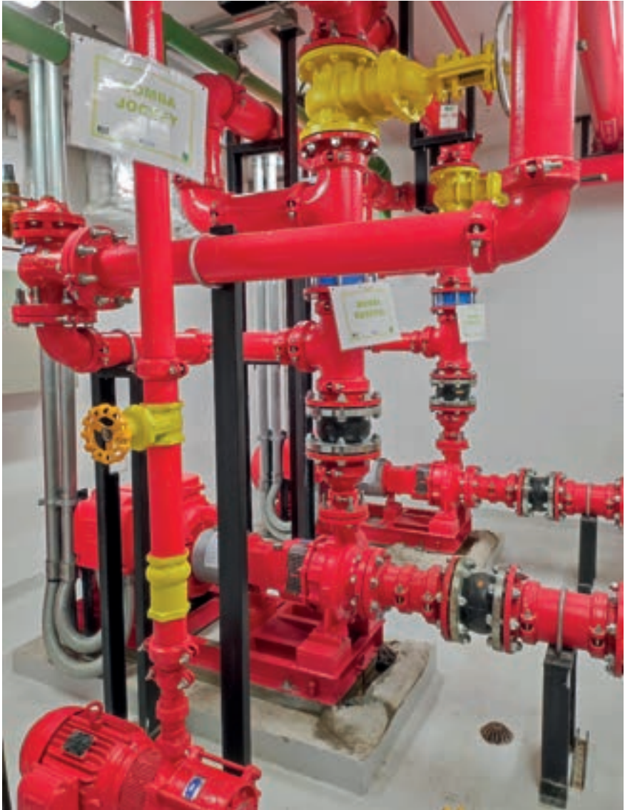
Figura 112 – Casa de Bombas de Hidrantes
