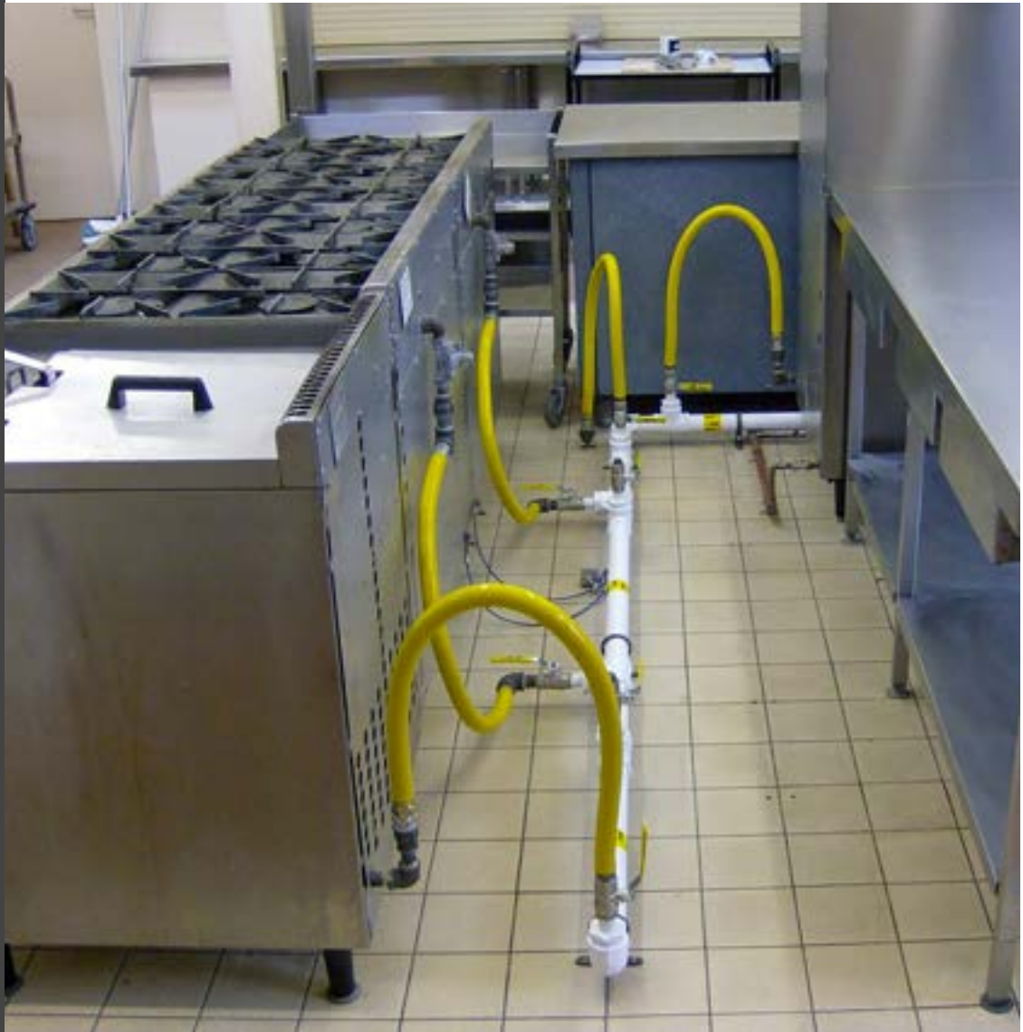
Figura 91 – Tubulação de Gás que Alimenta Cozinha
