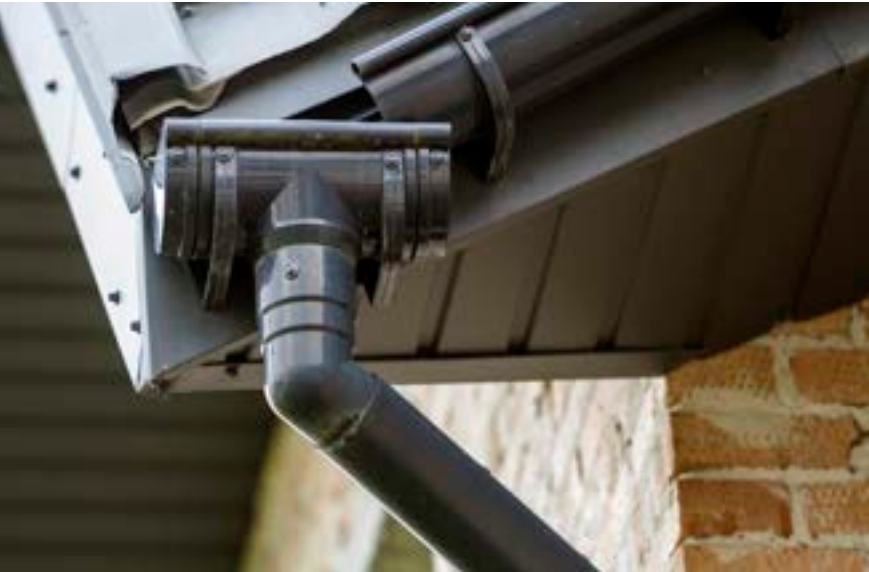
Figura 89 – Captação de Água Pluvial em Calha
