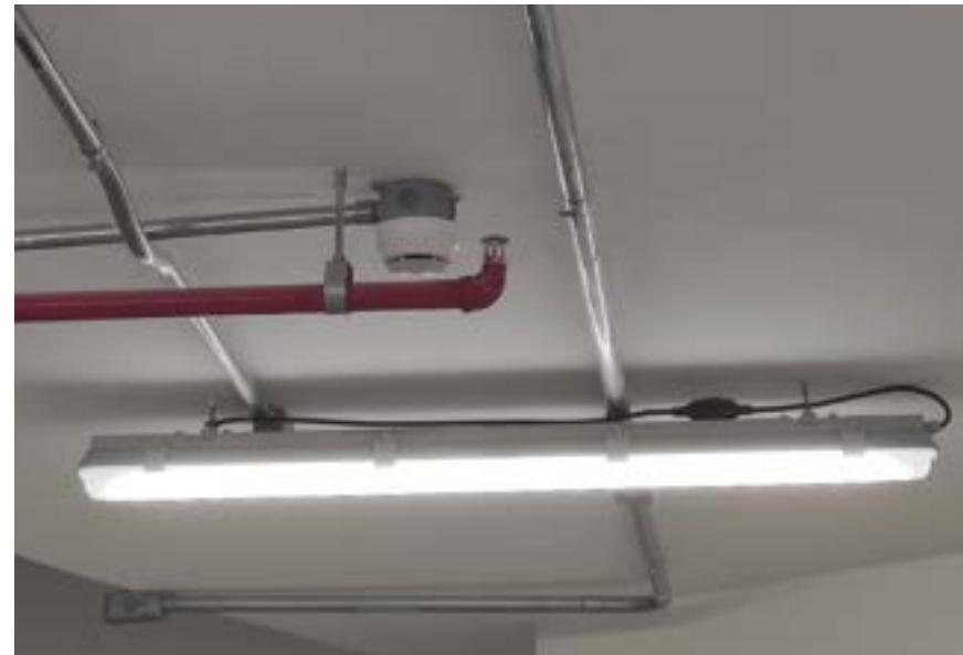
Figura 122 – Rabichos com Tomadas para a Instalação das Luminárias
