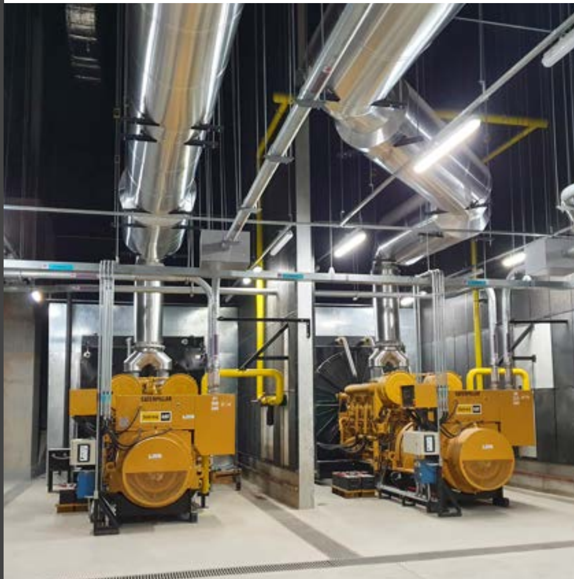
Figura 123 – Sala Montada com Dois Grupos Geradores Abastecidos a Gás e Óleo Diesel
