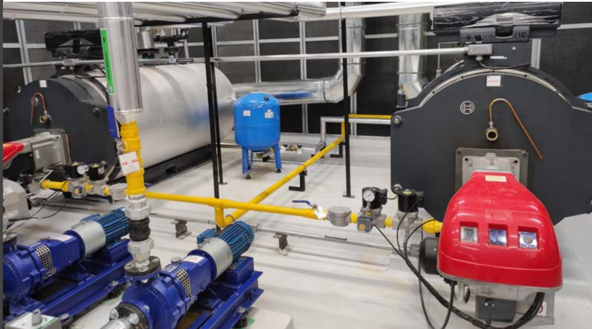
Figura 92 – Tubulação de Gás que Alimenta Geradora de Água Quente
