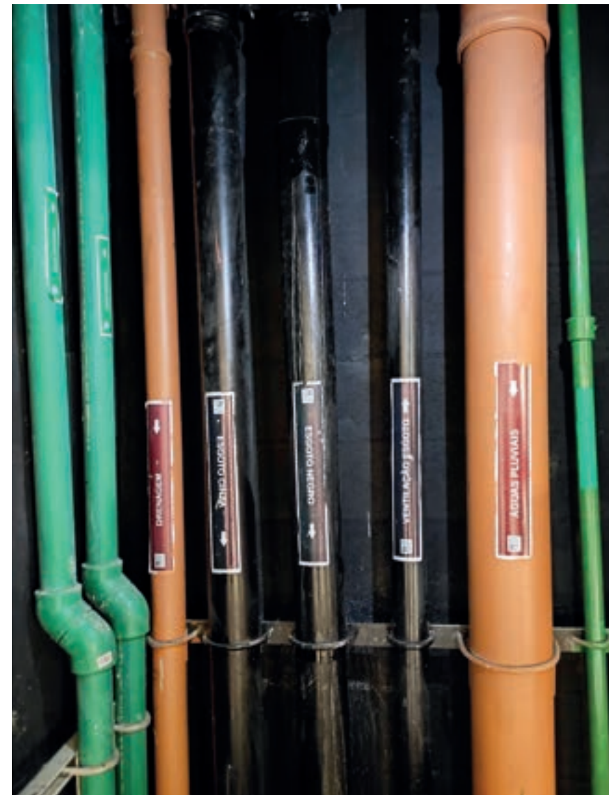
Figura 85 – Rede de Esgoto Posicionada em Shaft
