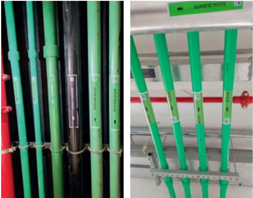
Figuras 73 e 74 – Exemplo de Identificação Correta para Prumadas Instaladas em uma Unidade Hospitalar
