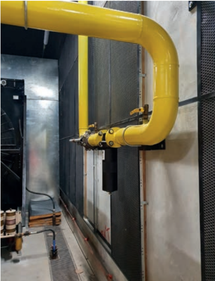
Figura 90 – Tubulação que Alimenta Gerador de Energia
