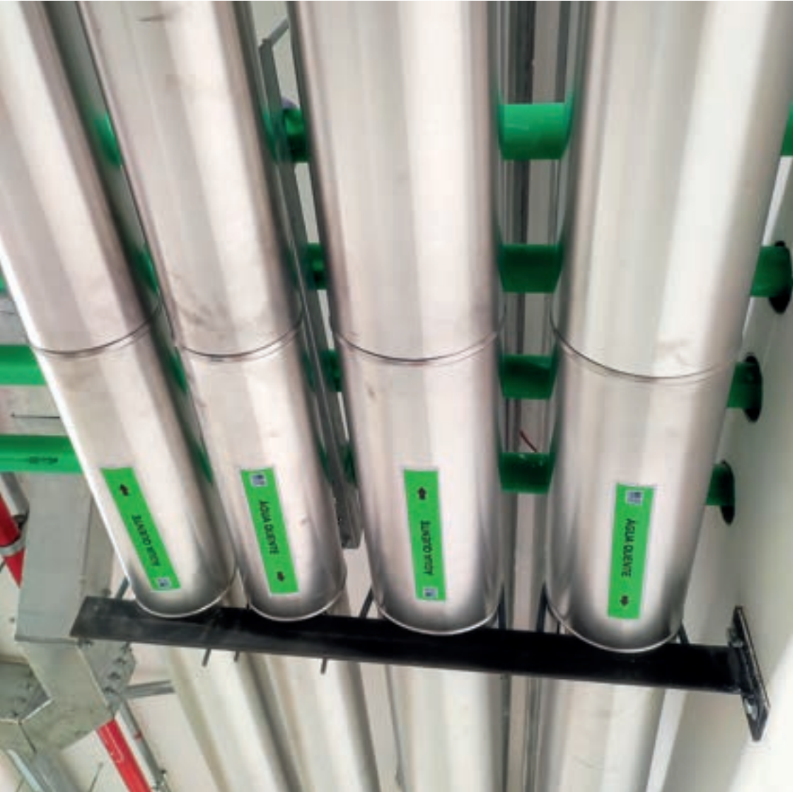
Figura 82 – Isolamento e identificação de Água Quente junto ao Teto
