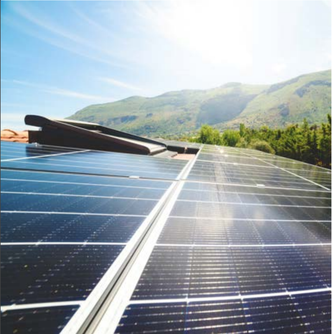
Figura 81 – Placas Solares Instaladas na Cobertura da Edificação
