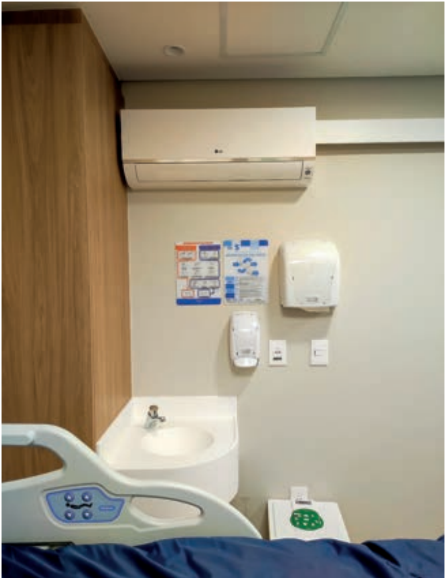
Figura 145 – Quarto com Equipamento Instalado
