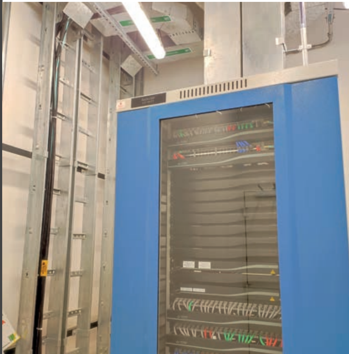
Figura 129 – Sala de Racks
