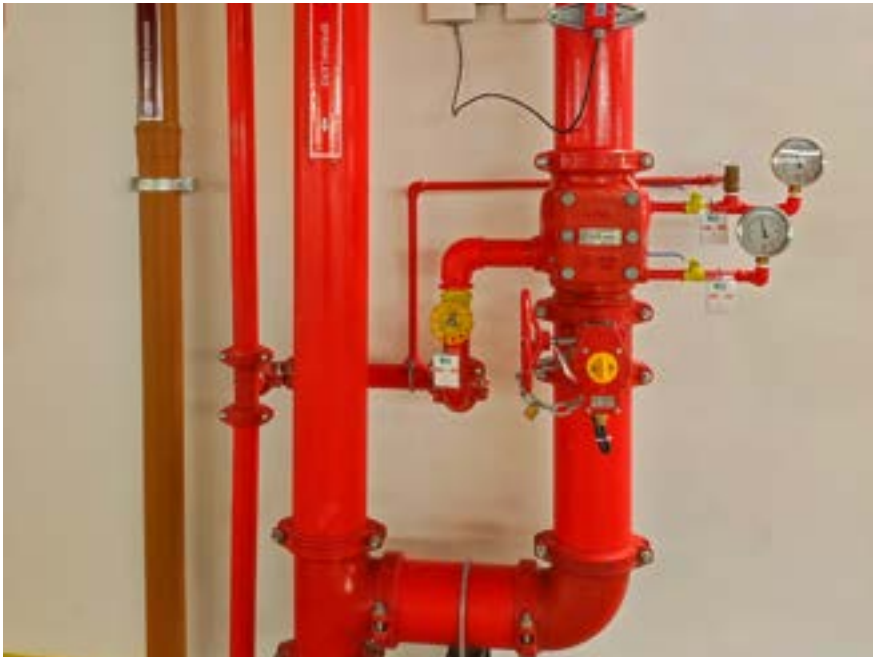
Figura 113 – Válvula de Governo Instalada
