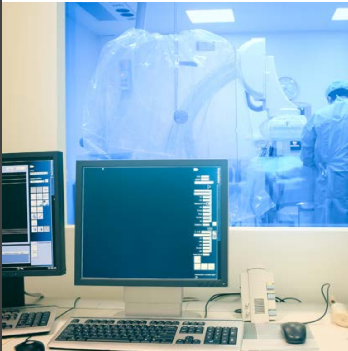
Figura 52 – Visor Plumbífero Instalado em Sala Técnica
