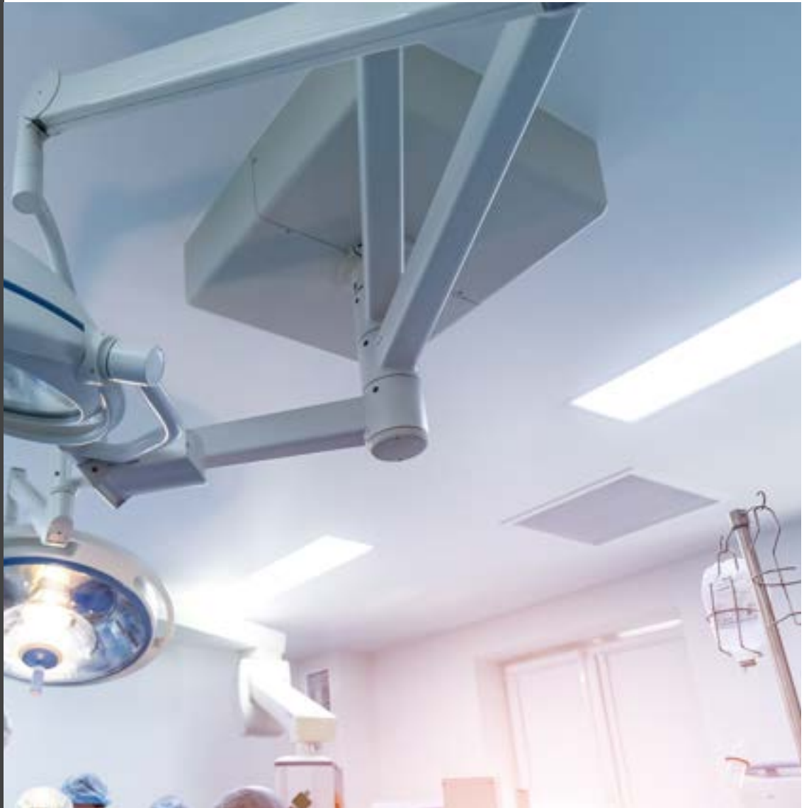
Figura 70 – Forro Fixo Instalado em Sala Cirúrgica
