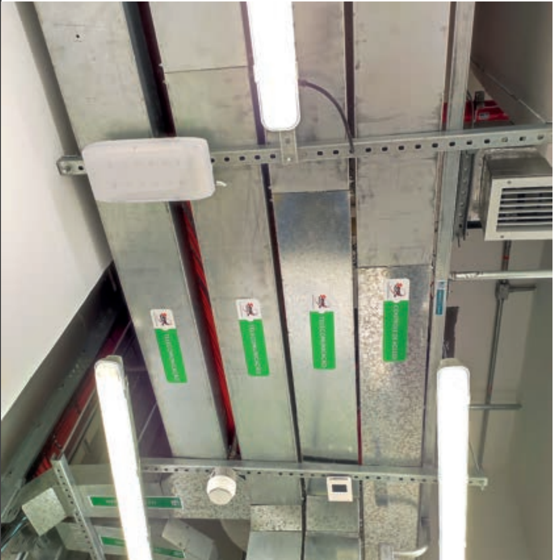
Figura 128 – Instalações Eletrônicas no Forro
