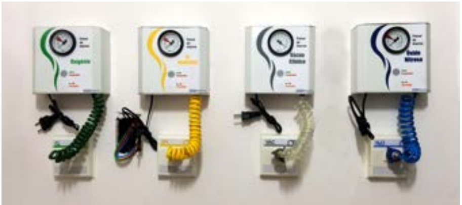
Figura 95 – Painel de Alarme Emergencial
