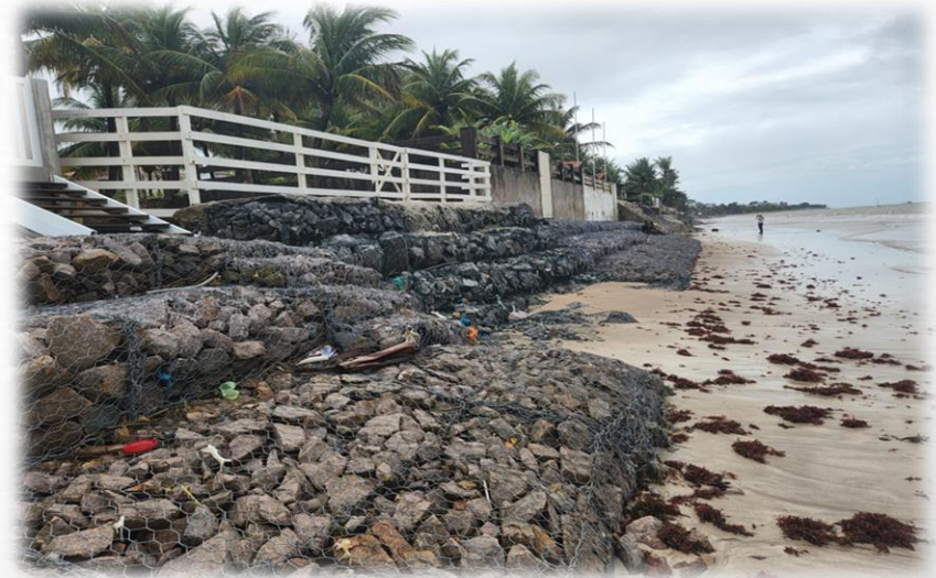
PA 1.24.000.000431/2022-01, Erosão em Cabedelo/PB
