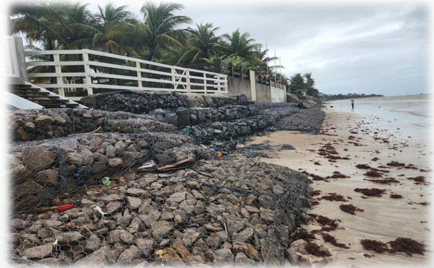
PA 1.24.000.000431/2022-01, Erosão em Cabedelo/PB
