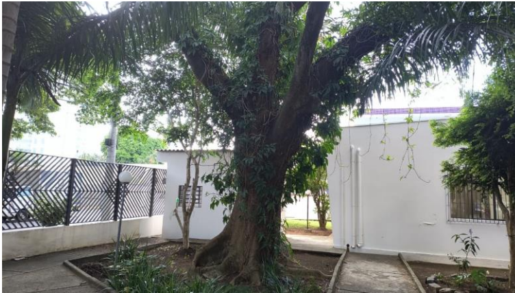
Imagens 08 a 10: Árvores próximas ao muro de divisa – Rua Claro Gomes (nº 01, 12 a 21, 39 e 40).
