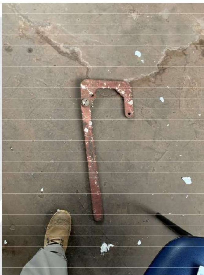
FOTO 14 – CONJUNTO DE MANOBRA DE EMERGÊNCIA NO CHÃO E SEM SINALIZAÇÃO
