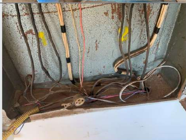
Foto SRT09.3/1 – Elevadores, INSPEÇÃO: CASA DE MÁQUINAS
