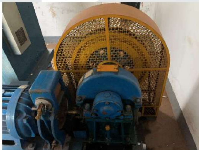
FOTO 05 – CONJUNTO DE TRAÇÃO DOS ELEVADORES
