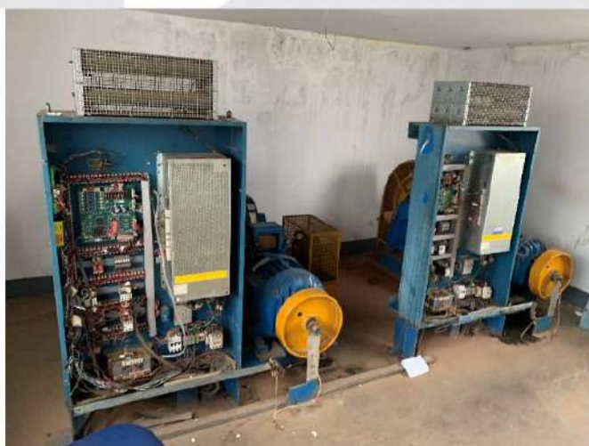
FOTO 03 - CASA DE MÁQUINAS DOS ELEVADORES
