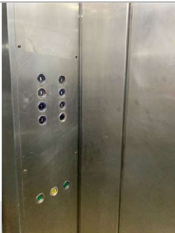
Foto SRT04.3/1 – Elevadores, INSPEÇÃO: PAINEL INTERNO DE COMANDO
