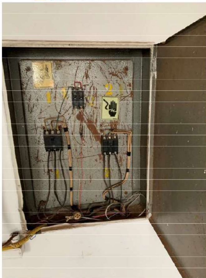
FOTO 04 – ALIMENTAÇÃO DOS EQUIPAMENTOS DA CASA DE MÁQUINAS DOS ELEVADORES
