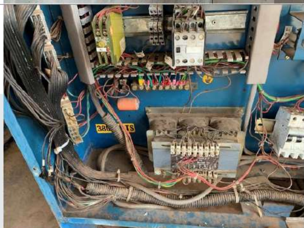
Foto SRT08.3/1 – Elevadores, INSPEÇÃO: QUADRO DECOMANDO, SEM IDENTIFICAÇÃO, SEM SELO OU QUALQUER OUTRO CONTROLE DOS TESTES DE DESEMPENHO E SEGURANÇA. ITEM 16.1.3 DA NM 207:1999
