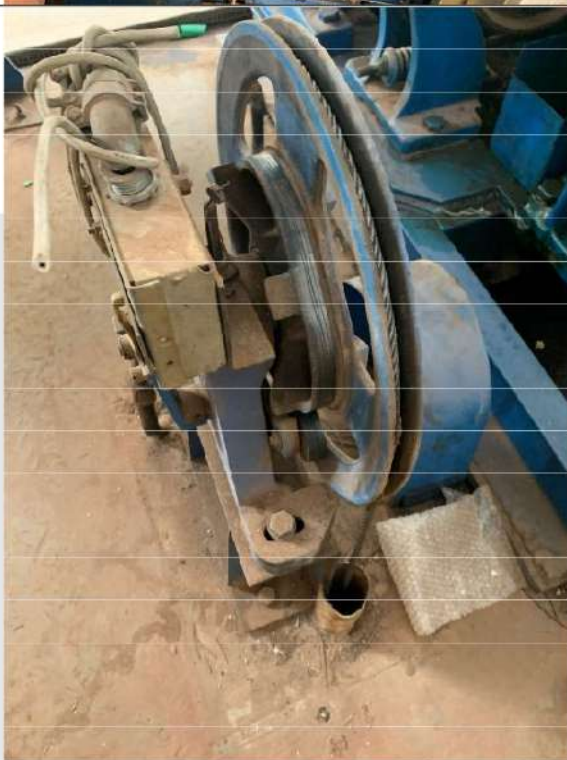
Foto SRT13.3/1 – Elevadores, INSPEÇÃO: CASA DE MÁQUINAS
