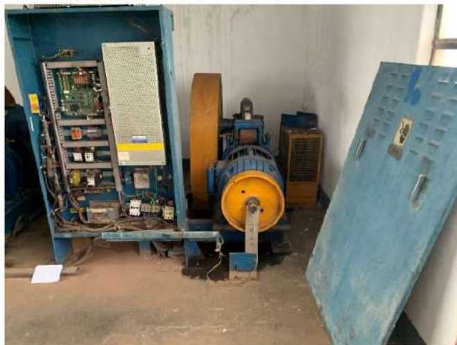
FOTO 13 – CASA DE MÁQUINAS DOS ELEVADORES – QUADRO DE COMANDO E CONJUNTO DE TRAÇÃO
