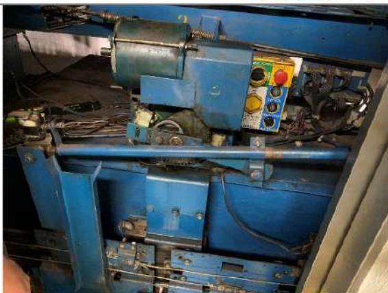
Foto SRT12.3/1 – Elevadores, INSPEÇÃO: OPERADOR DE PORTA DE CABINE
