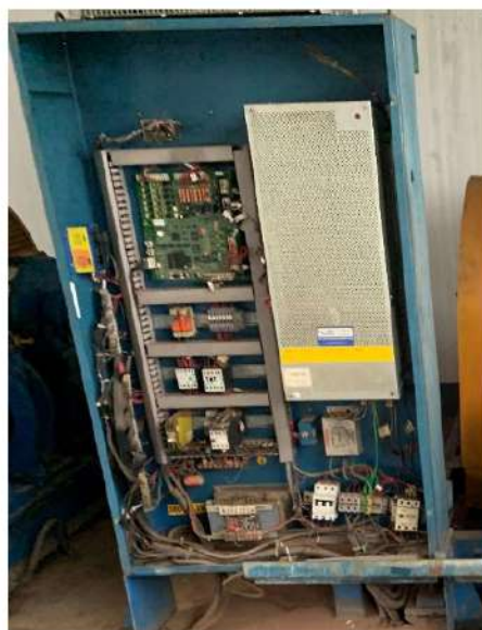
FOTO 08 – QUADRO DE COMANDO
