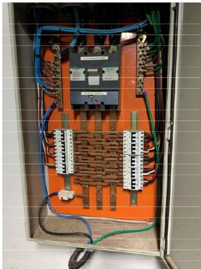
FOTO 10 – DISJUNTORES DE ALIMENTAÇÃO DOS ELEVADORES NO QUADRO GERAL DE BAIXA TENSÃO DA EDIFICAÇÃO
