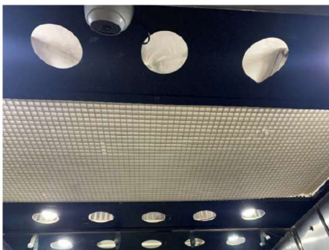
FOTO 17 – CABINE COM FORRO CONSERVADO E ILUMINAÇÃO INEFICIENTE NO INTERIOR DAS CABINES
