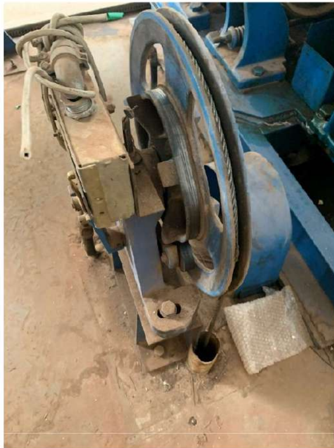
FOTO 06 - LIMITADORES DE VELOCIDADE DOS ELEVADORES
