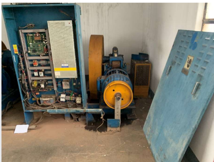
FOTO 14 – CASA DE MÁQUINAS DOS ELEVADORES – QUADRO DE COMANDO E CONJUNTO DE TRAÇÃO
