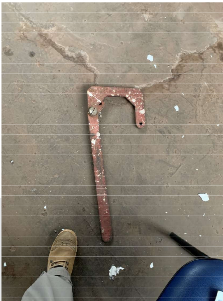
FOTO 15 – CONJUNTO DE MANOBRA DE EMERGÊNCIA NO CHÃO E SEM SINALIZAÇÃO
