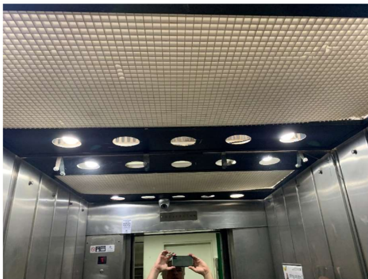
FOTO 19 – CABINE COM FORRO CONSERVADO E ILUMINAÇÃO INEFICIENTE NO INTERIOR DAS CABINES
