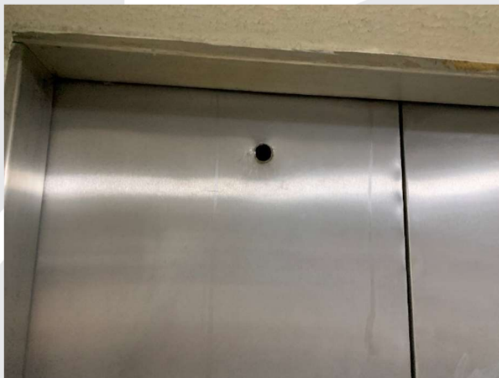
FOTO 08 – FALTA DISPOSITIVO DE ABERTURA DE PORTA DE PAVIMENTO EM VÁRIOS ANDARES
