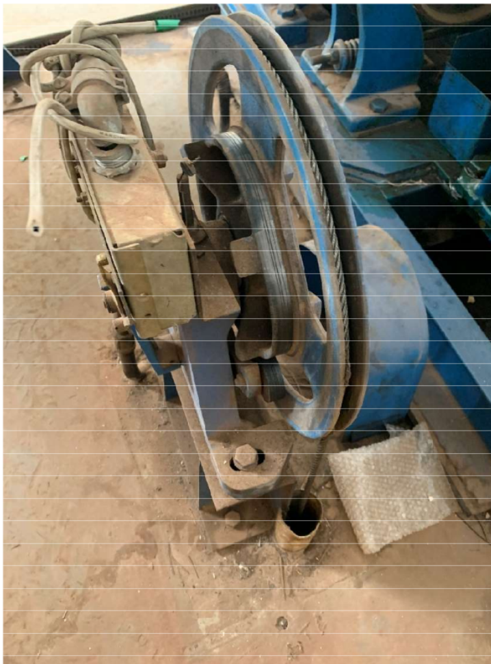
FOTO 06 - LIMITADORES DE VELOCIDADE DOS ELEVADORES
