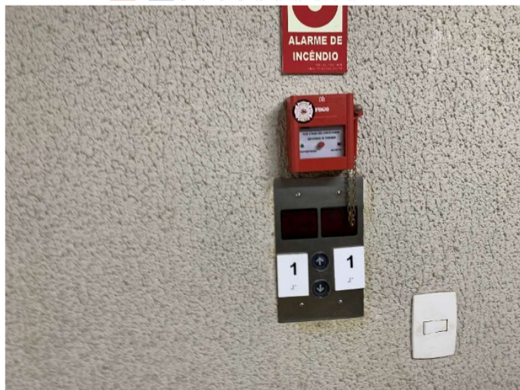
FOTO 12 – BOTOEIRAS DE PAVIMENTO DOS ELEVADORES
