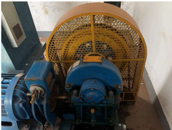
FOTO 05 – CONJUNTO DE TRAÇÃO DOS ELEVADORES
