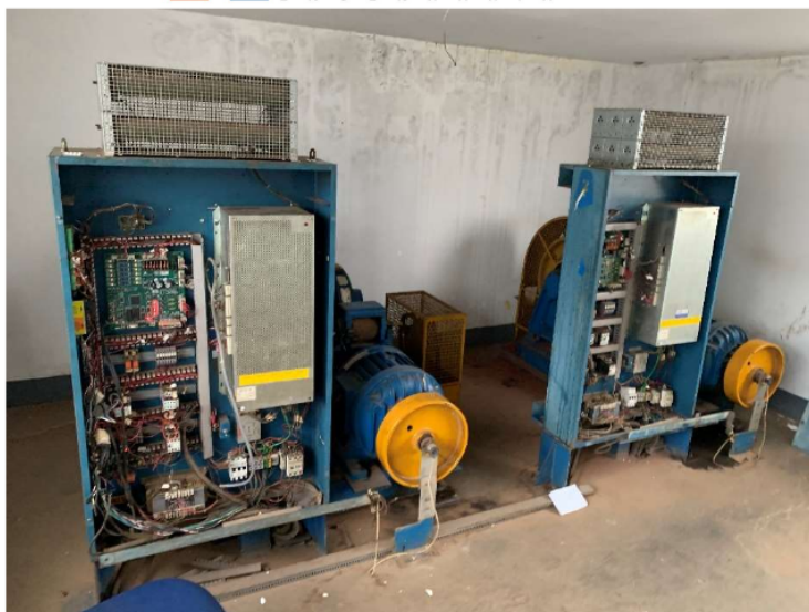
FOTO 03 - CASA DE MÁQUINAS DOS ELEVADORES
