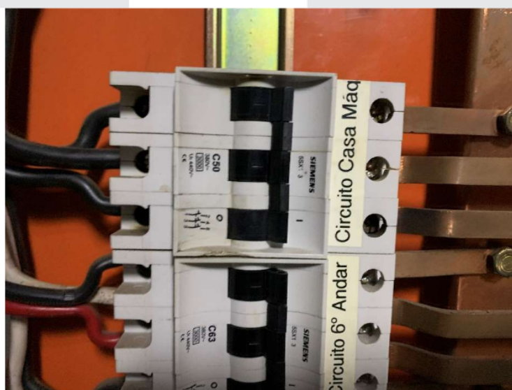
FOTO 12 – DISJUNTORES DE ALIMENTAÇÃO DOS ELEVADORES NO QUADRO GERAL DE BAIXA TENSÃO DA EDIFICAÇÃO
