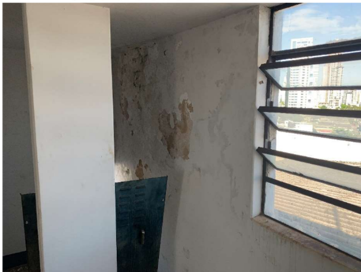
FOTO 16 – PAREDES DA CASA DE MÁQUINAS MOFADAS
