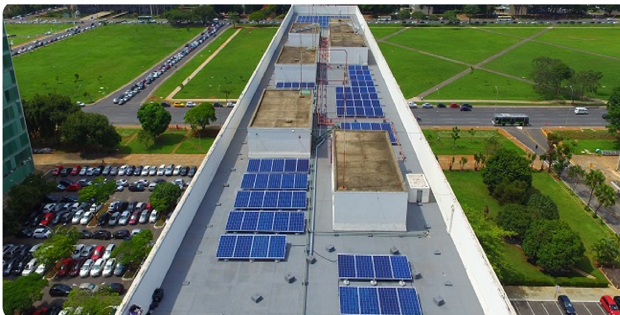
Sistema de geração distribuída solar fotovoltaica, instalado no telhado do edifício-sede do Ministério de Minas e Energia. Foto: Divulgação/MME, 2016
