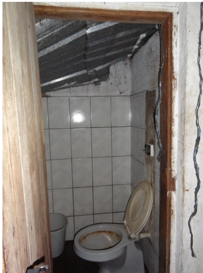
Banheiro em condições precária de manutenção e higiene, fiação exposta
