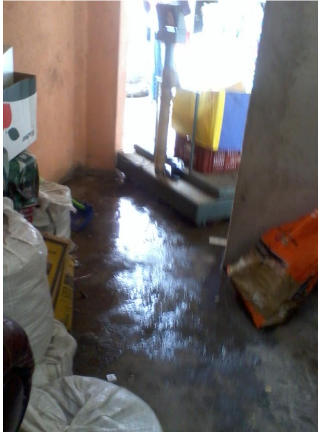
Esgoto transbordando no interior do galpão
