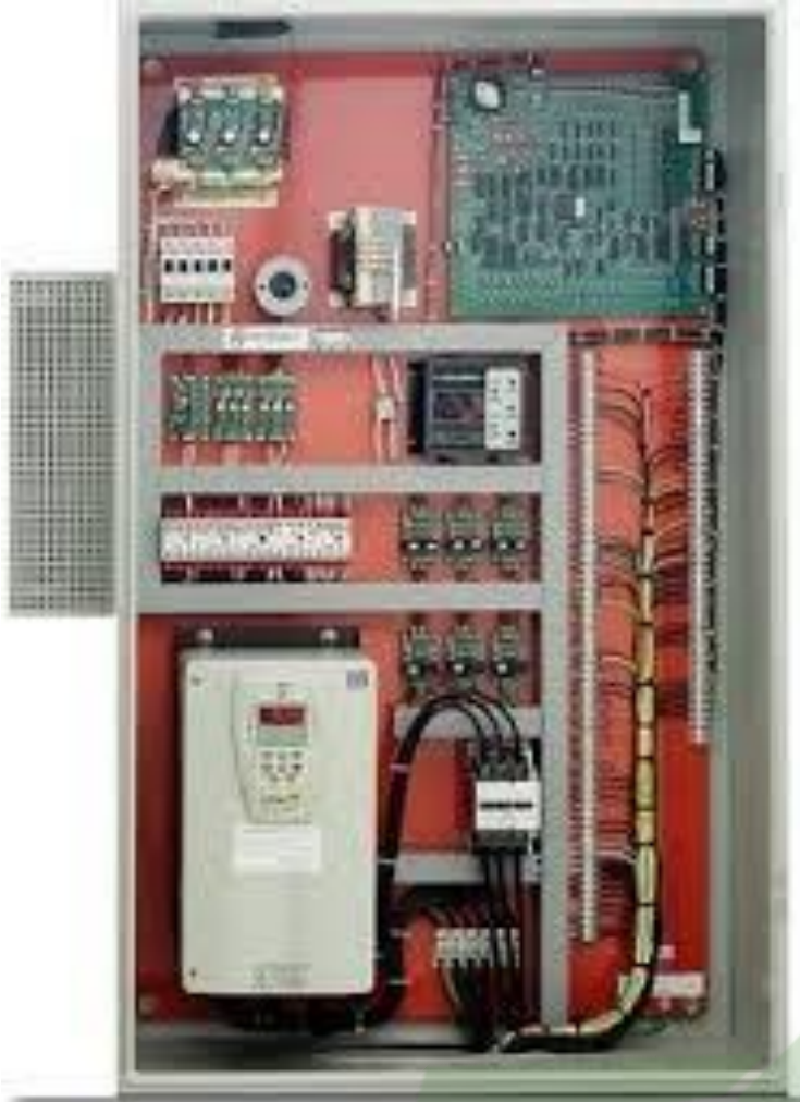
Quadro de comando
