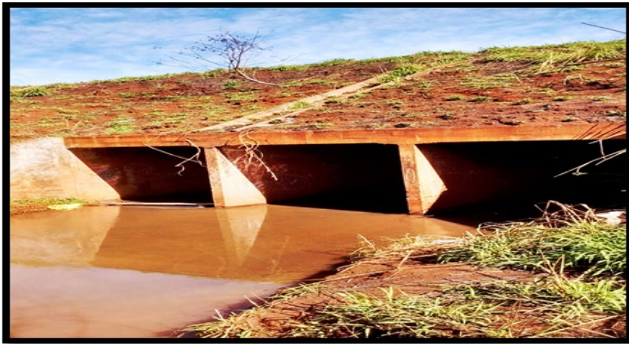
Figura 23 - Córrego Três Tubos – Ypiaury - Água insalubre.
