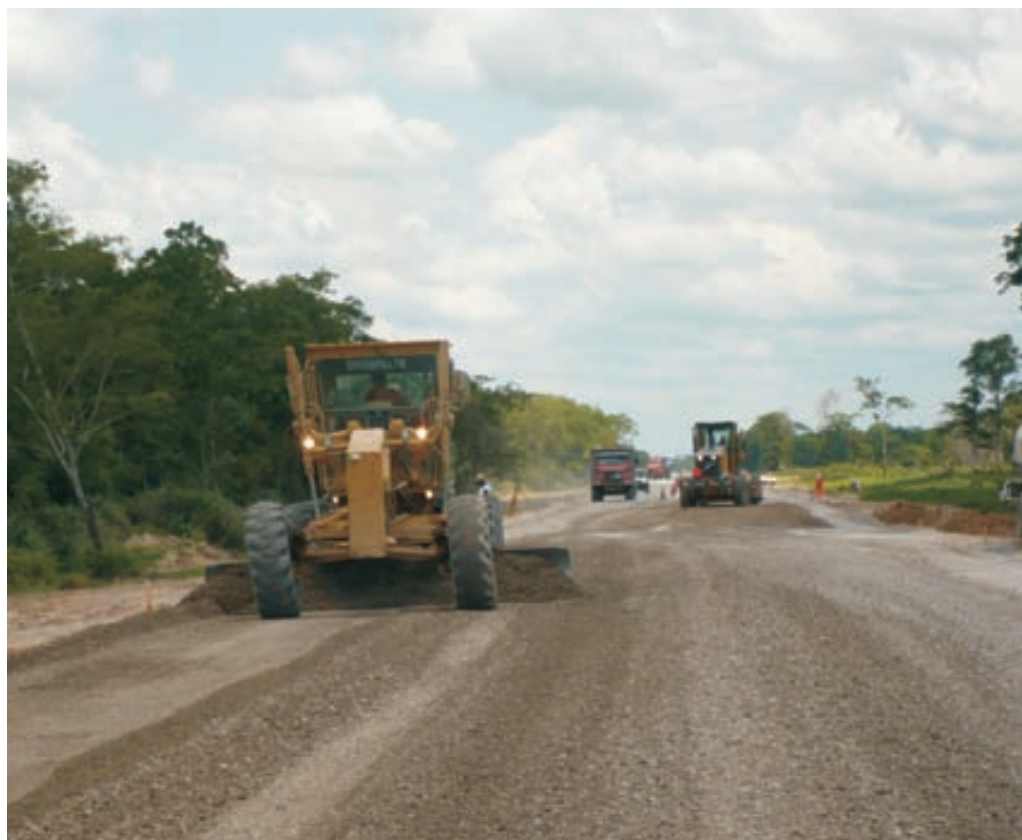
Obras de la Carretera El Carmén – Arroyo Concepción, Corredor Bioceánico, en Bolivia
