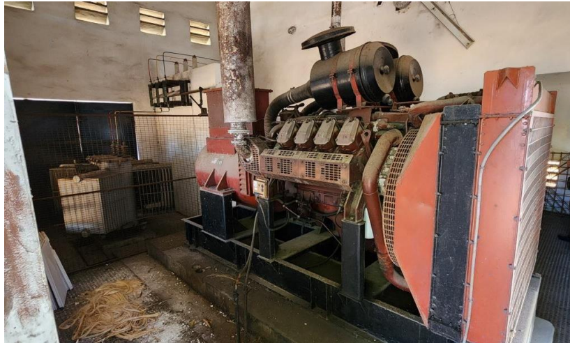
Figura 17 - Gerador e transformador de emergência fora de operação
