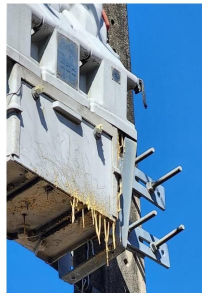
Figura 12 - Detalhe de sujidade de possível vazamento no conjunto medidor
