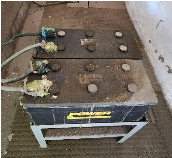
Figura 23 - Baterias do Gerador
