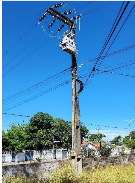
Figura 10 - Poste com ramal de entrada e conjunto de medição
