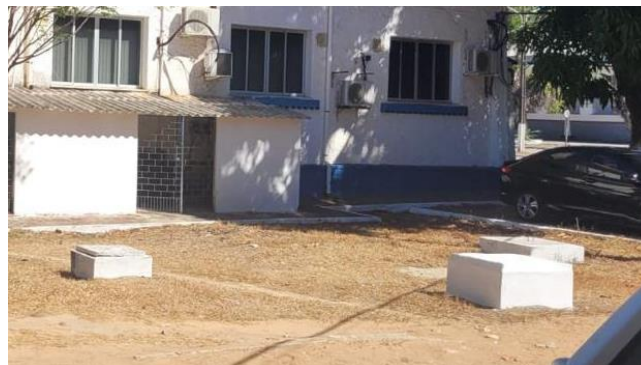
Figura 9 - Tanque séptico e sumidouro da Odontologia
