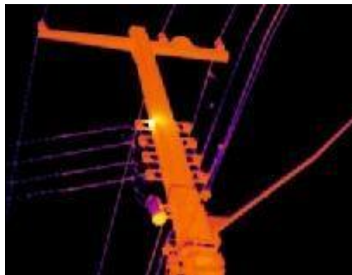
Figura 70 - Imagem de análise termográfica para identificação de defeitos em redes de energia.
