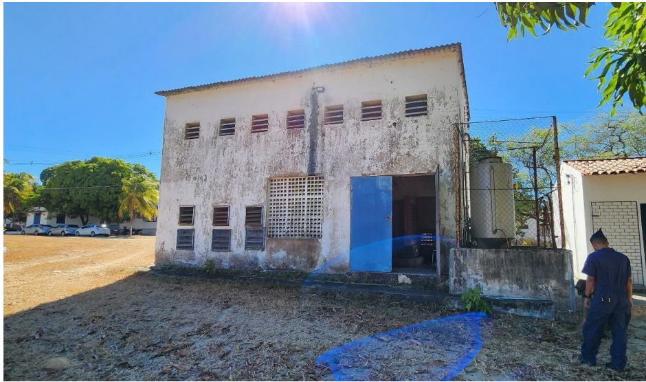
Figura 27 - Vista externa da subestação
