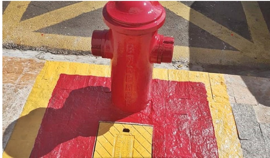
Figura 60 - Exemplo de hidrante urbano
