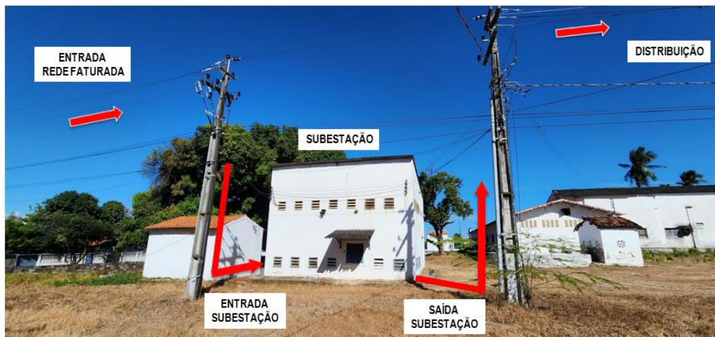
Figura 15 - Detalhe de entrada e saída da rede elétrica na subestação abrigada.
