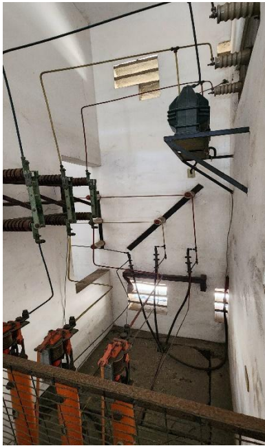
Figura 19 - Cubículo de proteção geral
