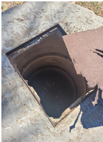
Figura 5 - Tampa de acesso ao poço de visita comprometida devido à corrosão
