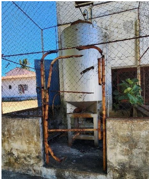
Figura 25 - Tanque de diesel
