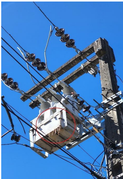
Figura 11 - Conjunto de medição trifásico
