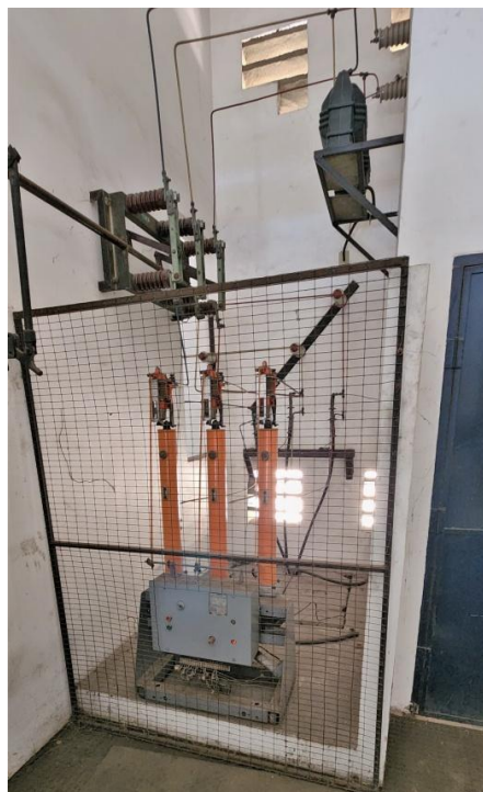
Figura 16 - Célula principal de entrada e disjuntor da subestação
