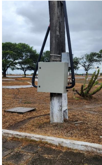
Figura 31 - Quadro de proteção Baixa Tensão - Prédio do Comando
