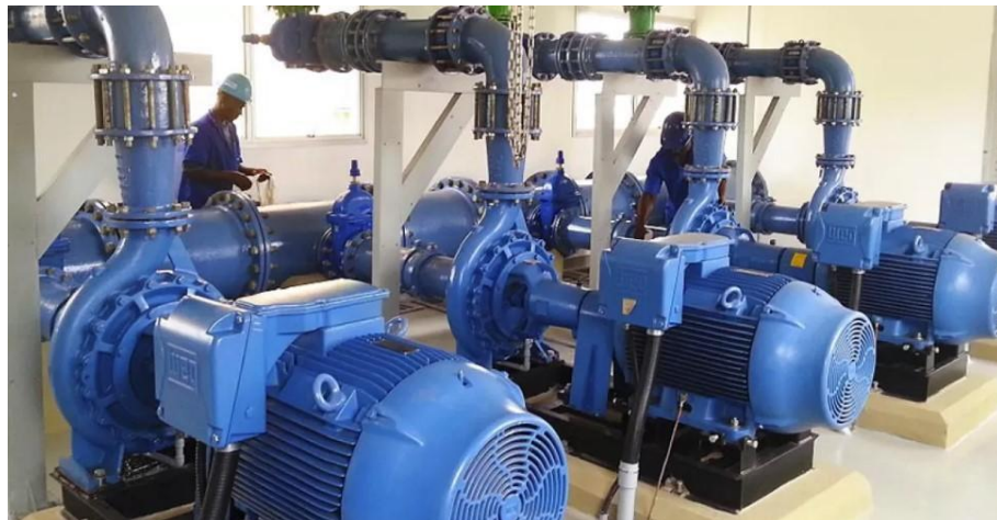
Figura 54 - Exemplo de casa de bombas
