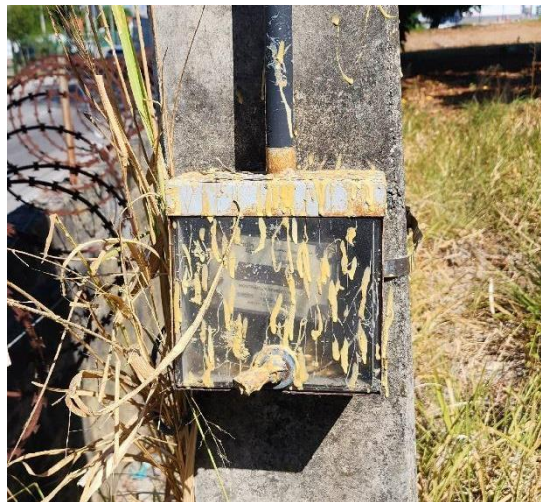
Figura 13 - Caixa do mostrador do medidor de energia
