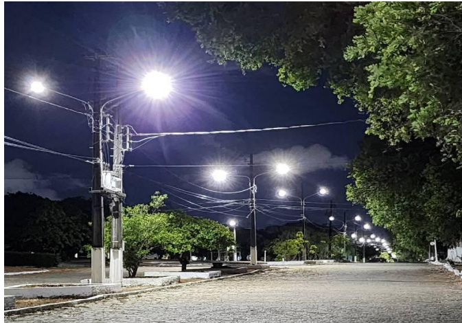
Figura 33 - Iluminação das vias de circulação com luminária do tipo LED.
