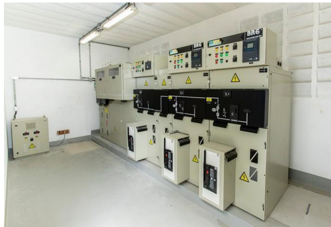
Figura 67 - Modelo de cubículos de média tensão blindado
