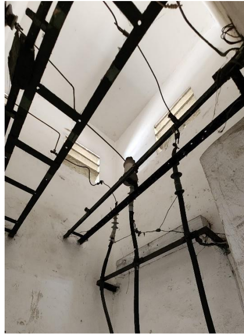
Figura 20 - Ramal de entrada 13,8 kV
