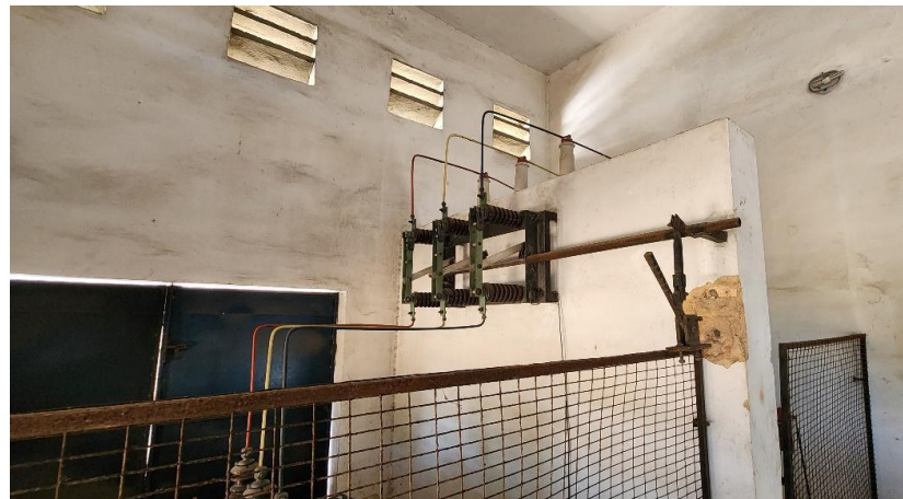
Figura 22 - Chave seccionadora do transformador com haste de manobra quebrada
