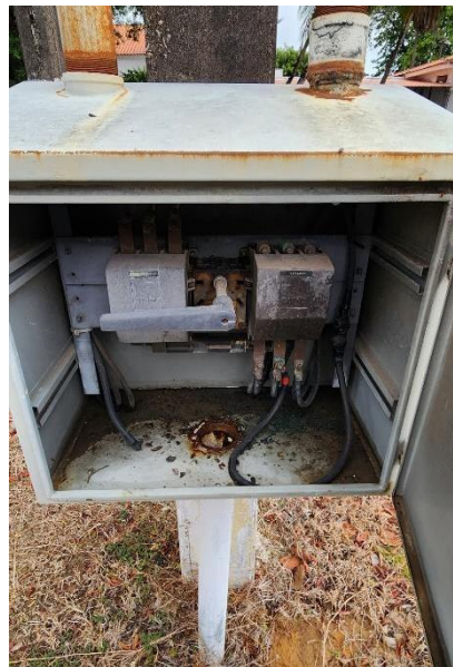
Figura 32 - Chave de reversão instalada na base do poste fora de operação
