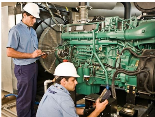
Figura 71- Manutenção preventiva e corretiva de grupo gerador
