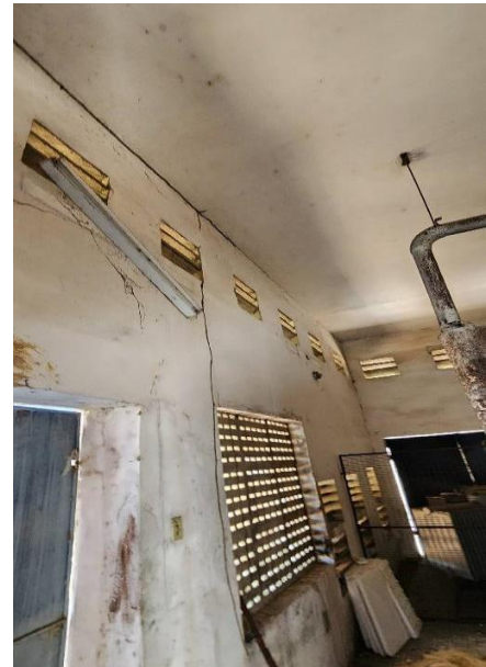
Figura 26 - Vista interna da subestação
