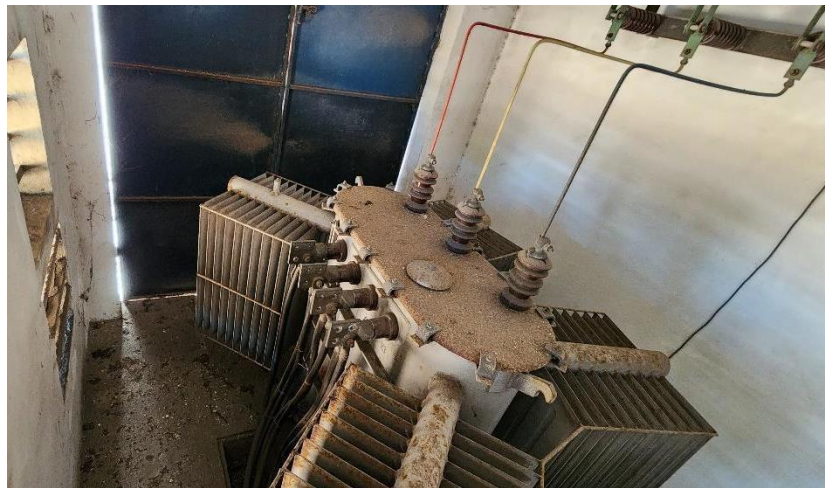
Figura 21 - Transformador do sistema de geração de emergência fora de operação
