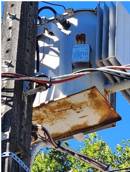
Figura 29 - Transformador 112,5 kVA com pontos de corrosão
