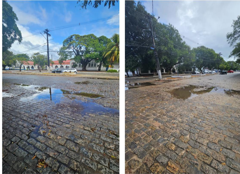
Figuras 45 e 46 – Acúmulo de água pós chuva
