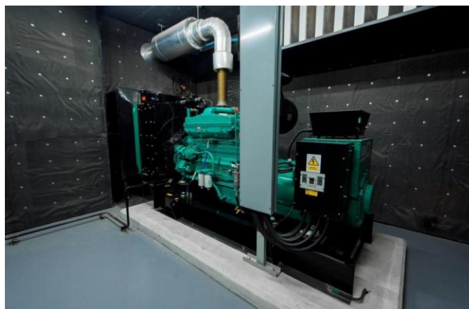
Figura 69 - Referência de Gerador de Emergência abrigado em sala com tratamento acústico.
