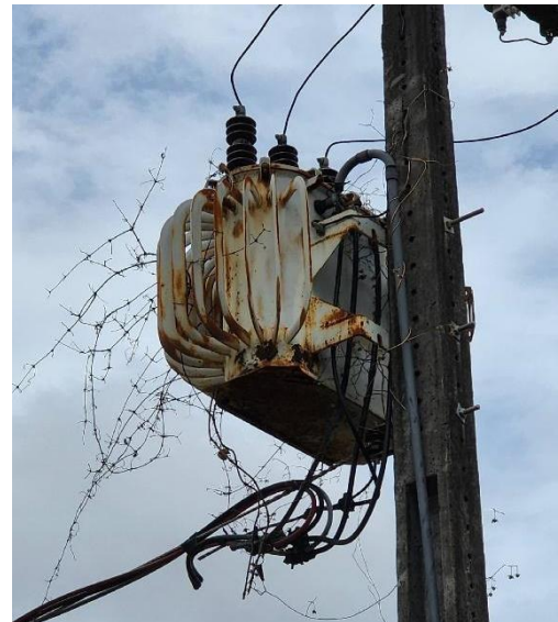
Figura 30 - Transformador 75 kVA com pontos de corrosão e vegetação
