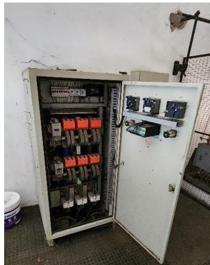
Figura 18 - Quadro de transferência automática (QTA)
