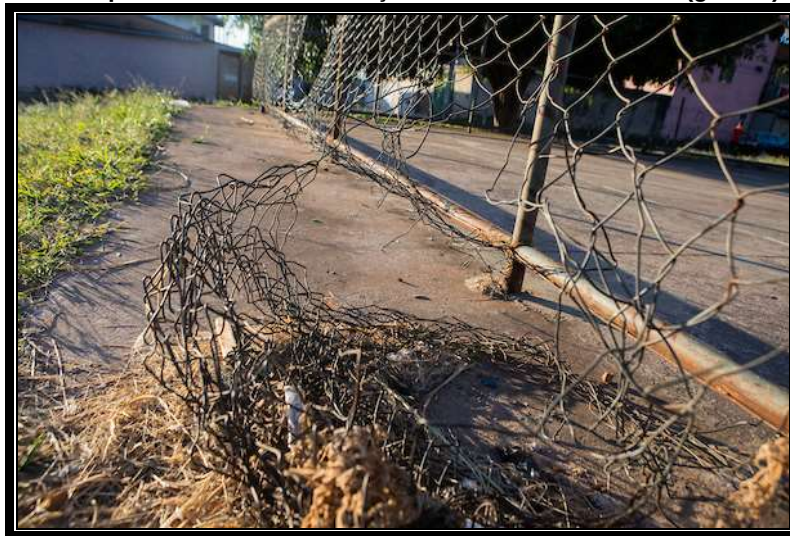
Imagem 19 - Exemplo de falta de manutenção de estrutura metálicas (grades) em quadra
