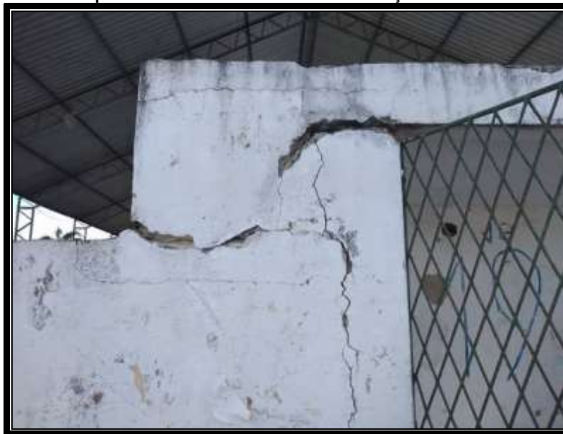
Imagem 17 - Exemplo de falta de cuidado e/ou manutenção de estrutura de concreto.
