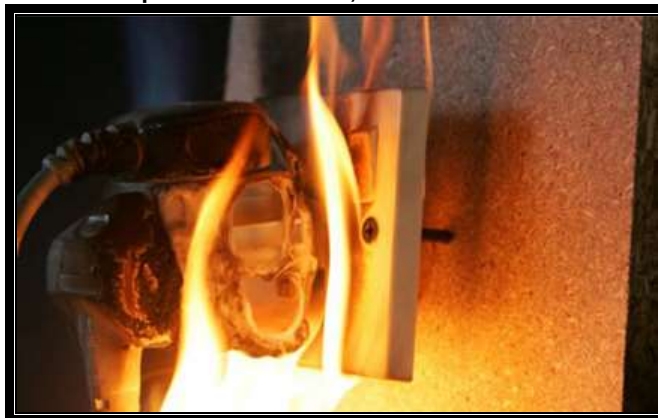
Imagem 26 – exemplo de curto circuito, decorrente de falta de manutenção.
