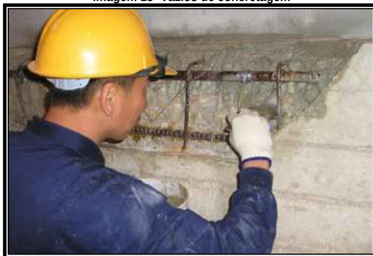
Imagem 18 -Vazios de concretagem
