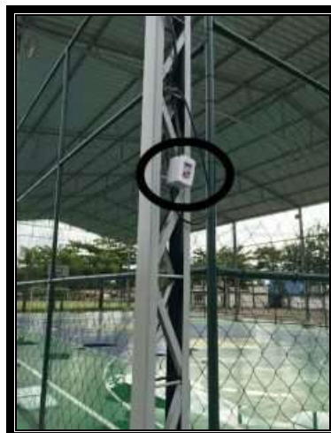
Imagem 22 - Caixa de luz exposta a chuva. Risco de choque elétrico
