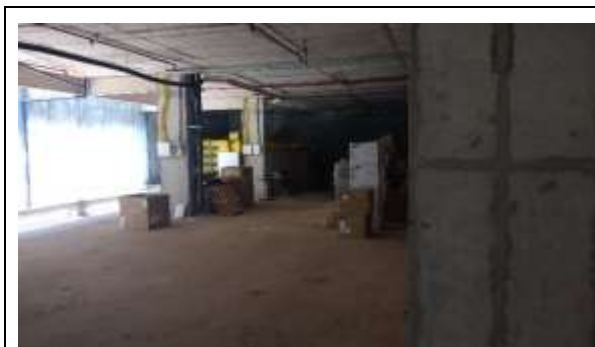
Foto 5: Espaço inacabado do Pavimento “0” (Semienterrado), para o qual estava prevista a instalação de restaurante e banco, espaço esse que está sendo utilizado como depósito. Brasília (DF), 20 de fevereiro de 2017.
