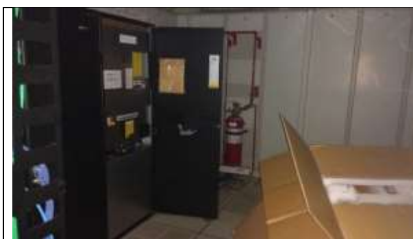
Foto 11: Sala-cofre – visão geral, onde se identifica vários equipamentos que, segundo os servidores do ME que acompanharam a vistoria, estariam danificados devido a enchente ocorrida no local, em dezembro de 2014. Brasília (DF), 20 de fevereiro de 2017.
