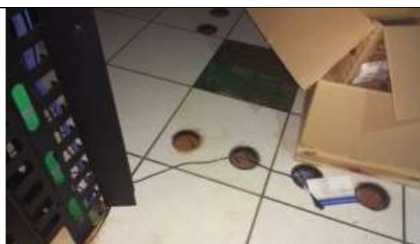
Foto 12: Sala-cofre – visão parcial das instalações, com sinais de ausência de manutenção. Brasília (DF), 20 de fevereiro de 2017.
