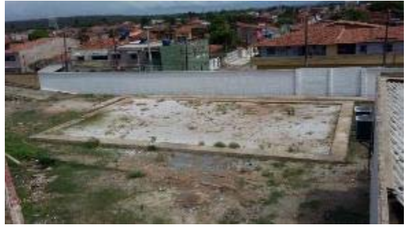
Foto 04 – Pista de corrida e quadra de areia inacabadas, Maceió/AL, 23 de fevereiro de 2015.
