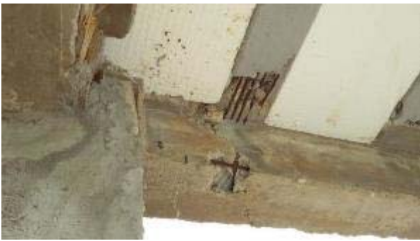
Foto 03 – Ferragens com recobrimento deficiente na estrutura do reservatório (viga e laje) , Maceió/AL, 23 de fevereiro de 2015.
