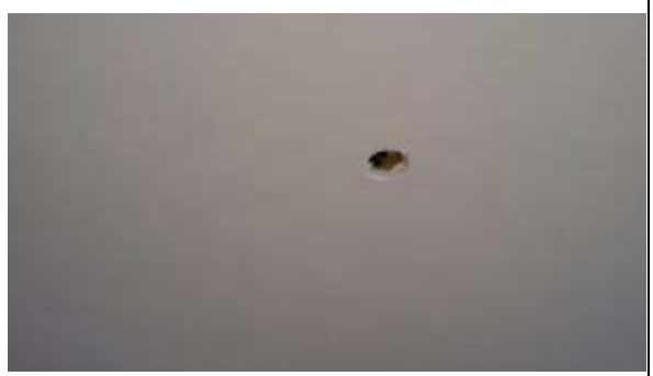
Foto 06 – Instalações elétrica e luminária não concluídas, Maceió/AL, 23 de fevereiro de 2015.
