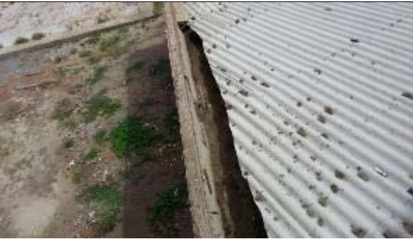
Foto 07 – Coberta com telha de fibrocimento cortada sem obedecer ao projeto (sem rufo de concreto), Maceió/AL, 23 de fevereiro de 2015.
