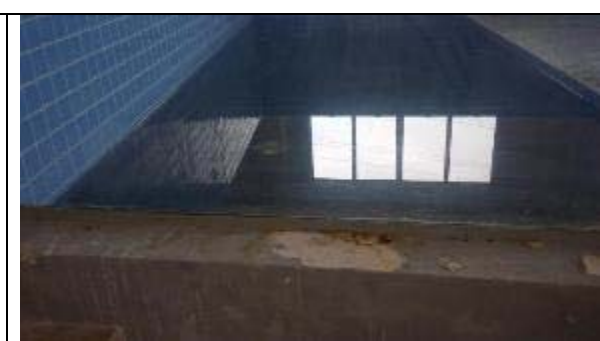
Foto 14 – Piscina com infiltração nos vidros laterais, Maceió/AL, 23 de fevereiro de 2015.
