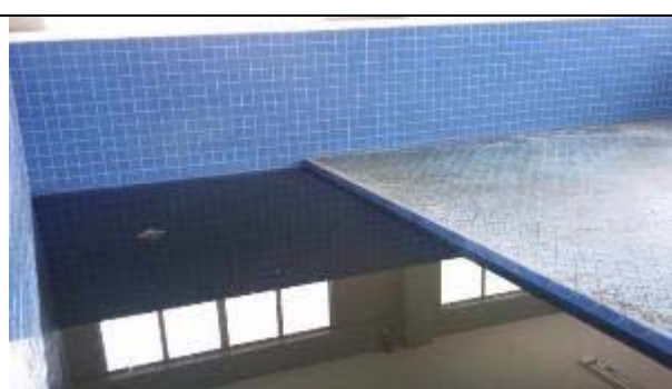
Foto 13 – Piscina com infiltração, Maceió/AL, 23 de fevereiro de 2015.
