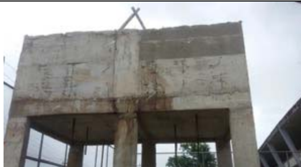
Foto 02 – Reservatório com infiltração, sem instalação hidráulica, sem acabamento (reboco e pintura) e com concreto segregado, Maceió/AL, 23 de fevereiro de 2015.
