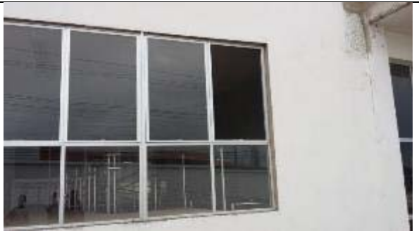
Foto 08 – Esquadria sem a colocação completa dos vidros e com vidros com fixação inadequada, Maceió/AL, 23 de fevereiro de 2015.
