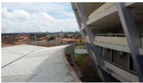
Foto 18 – Laje técnica sem impermeabilização, Maceió/AL, 23 de fevereiro de 2015.
