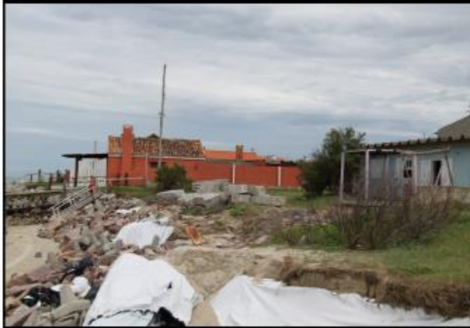
FIG. 27 – Estruturas de concreto, provavelmente peças de uma escada para dissipar as ondas ou para um muro.
