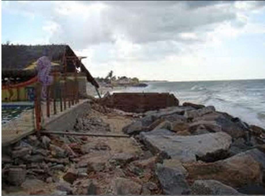
Fotos dos Danos nas Barracas de Praia – Praia de Icarai
