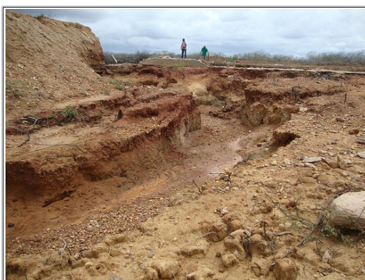
Erosão na base da barragem, à jusante.
