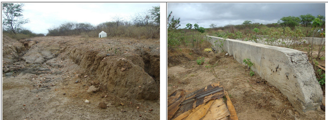
Erosão das valas escavadas.
