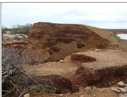
Queda de parte da parede da barragem.
