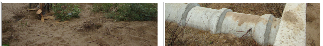
Evidência de passagem molhada em construção
