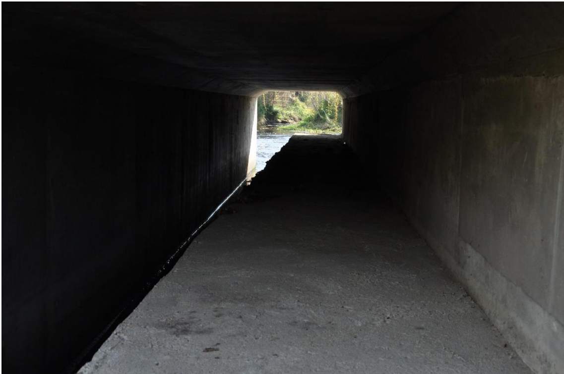
Passagem de fauna no vão de uma ponte, na BR-116/392/RS, município de Rio Grande.
