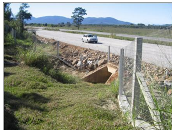
Figura 59– Exemplo de cerca instalada junto à passagem mista.
