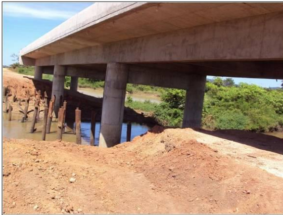
Figura 39 – Passagem seca sob a ponte do curso d'água nº 12, córrego Corgão, subtrecho 2.
