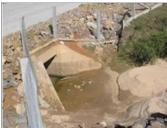
Figura 58– Exemplo de cerca instalada junto à passagem mista.
