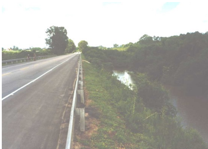
Acumulação de Água junto ao Aterro da Transposição do Arroio Pelotas - BR 116
