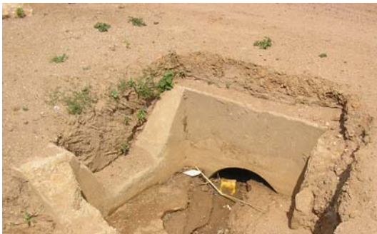
Foto E - bueiro entupido
