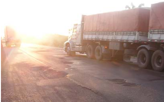
Foto A - buracos na pista de rolamento
