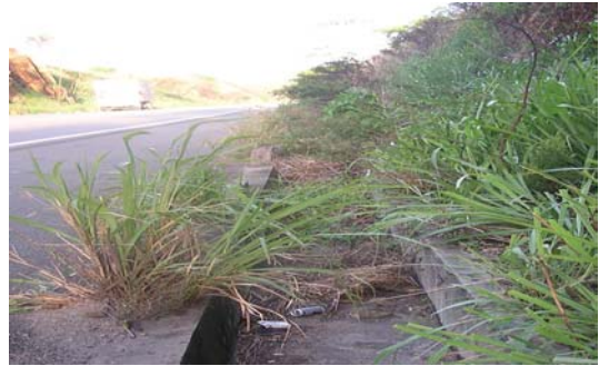
Foto B - acostamento e canaleta de drenagem invadidos pela vegetação
