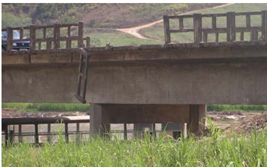
Foto C - guarda corpo da ponte danificado
