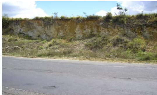
Foto F - pista sem sinalização e com buracos
