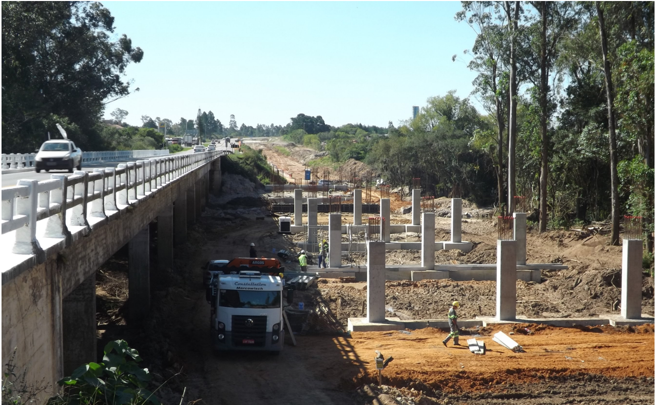
A ponte sobre o Arroio Grande, na divisa entre São Lourenço do Sul e Turuçu, é uma das Obras de Arte Especiais em construção ao longo dos 211 km
