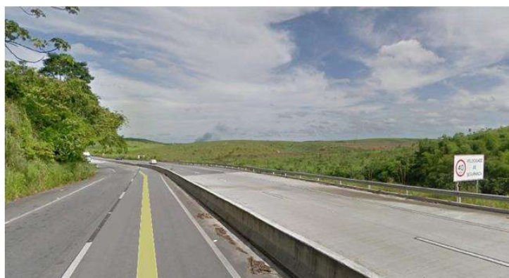
Figura 3 – Indicação da velocidade da via no trecho onde foi medido raio da curva na BR-101/AL.
