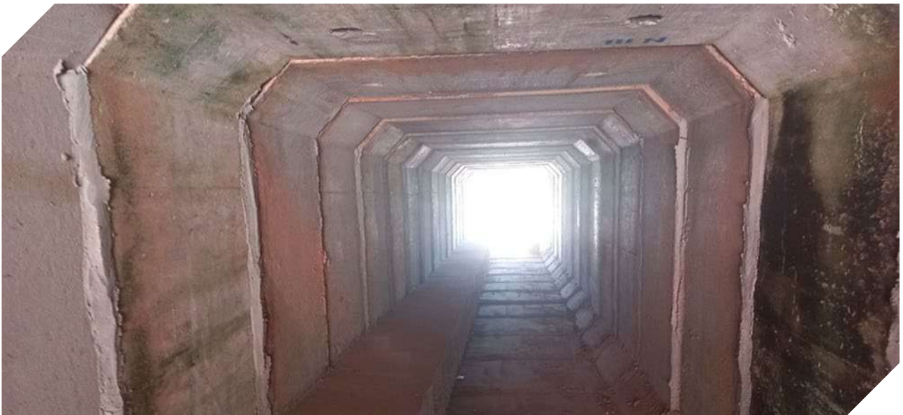
Figura 30. Bueiro simples celular de concreto adaptado com mureta lateral para travessia de fauna em ambiente seco. © Gestão Ambiental BR-230/PA, Consórcio STE/ProGaia e SRE/PA.
