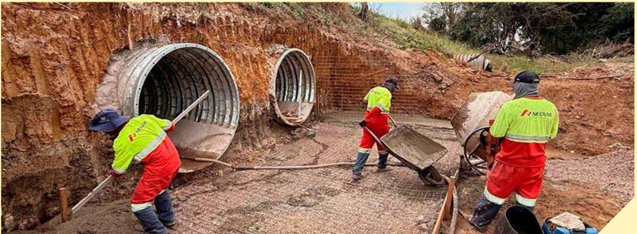
Figura 66. Correção de desnível de emboque com rachão em nova passagem inferior da BR-262/MS como medida de adequação para acesso da fauna silvestre; e obras em andamento para instalação de duas passagens inferiores de fauna. ©ViaFAUNA.
