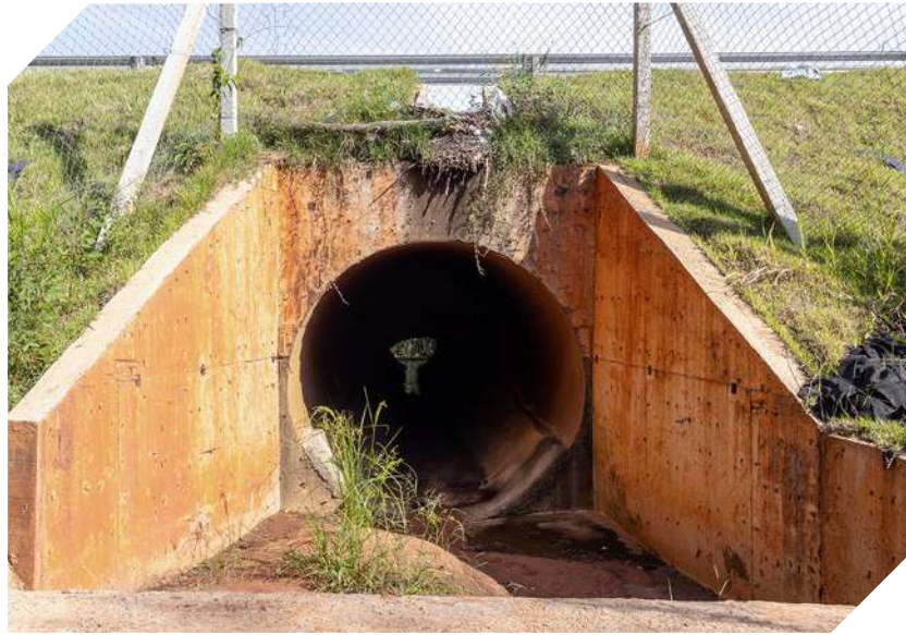
Figura 29. Drenagem fluvial (BSTM Ø 1,5 m) adaptada com cercamento de fauna em rodovia concedida no estado de São Paulo. © ViaFAUNA. Foto por Raphael de Oliveira.
