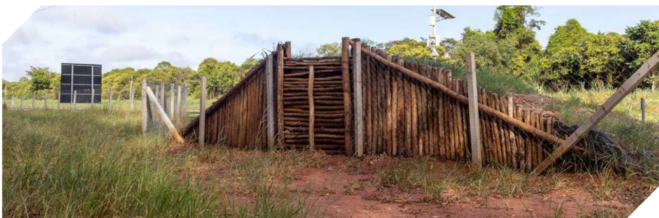
Figura 39. Cercamento associado a jump-out em rodovia sob concessão da Entrevias no estado de São Paulo. © ViaFAUNA. Foto por Raphael de Oliveira.
