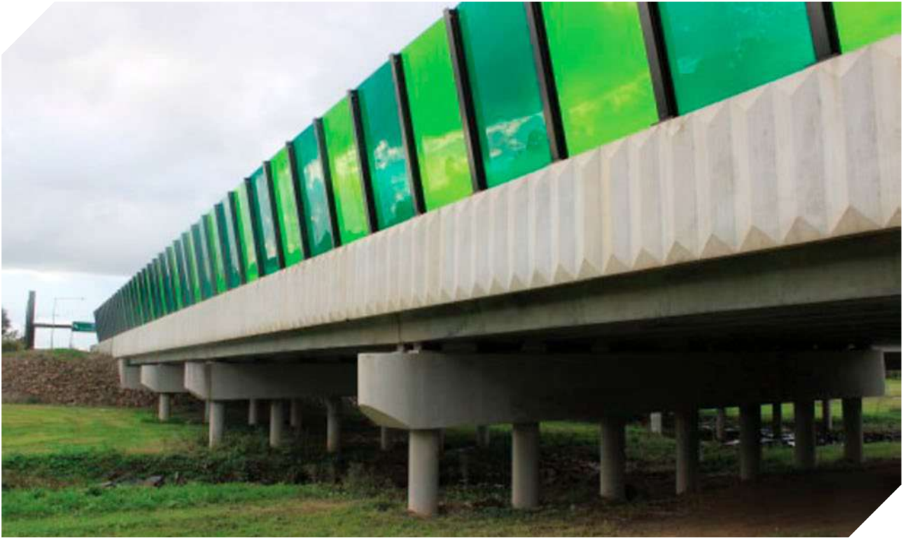
Figura 50. Defletores de voo compostos por placas, instalados sobre guarda-corpo de viaduto, evitando o voo das aves no mesmo nível do tráfego. © Rodney van der Ree (73).
