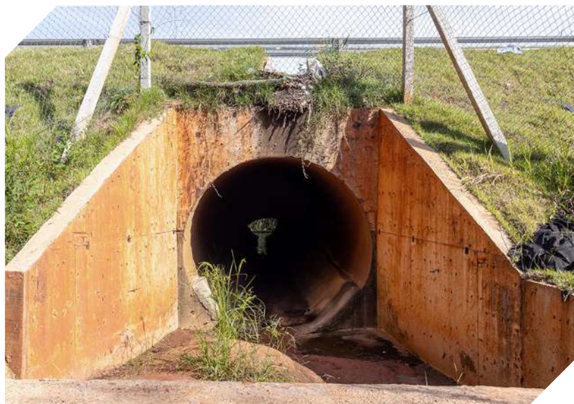
Figura 29. Drenagem fluvial (BSTM Ø 1,5 m) adaptada com cercamento de fauna em rodovia concedida no estado de São Paulo. © ViaFAUNA. Foto por Raphael de Oliveira.
