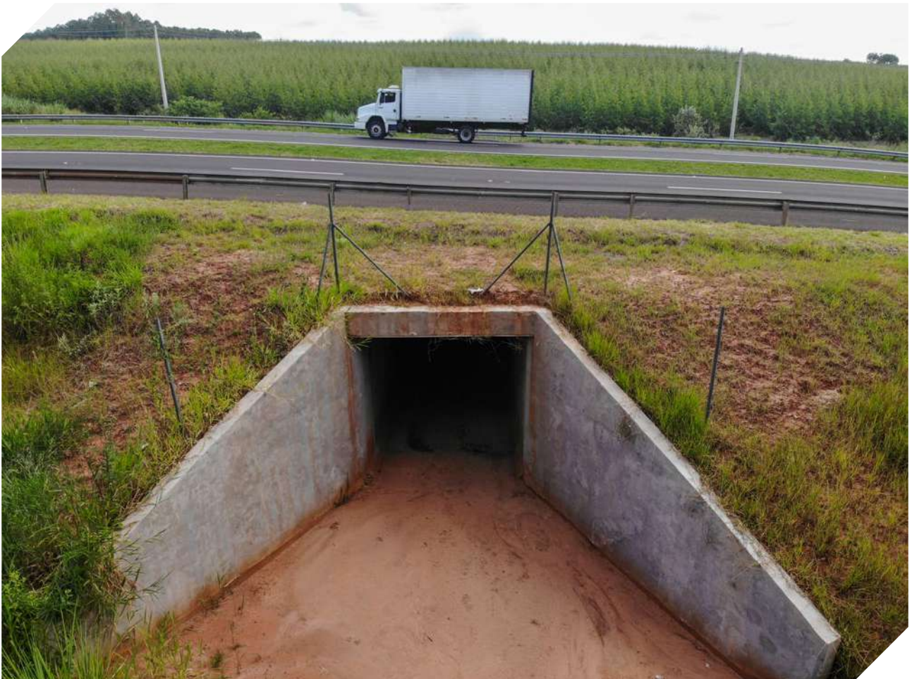
Figura 27. Passagem inferior de fauna do tipo BSCC 2 x 2 m cercada na SP-225, sob Concessão da CART. © ViaFAUNA. Foto por Raphael de Oliveira.
