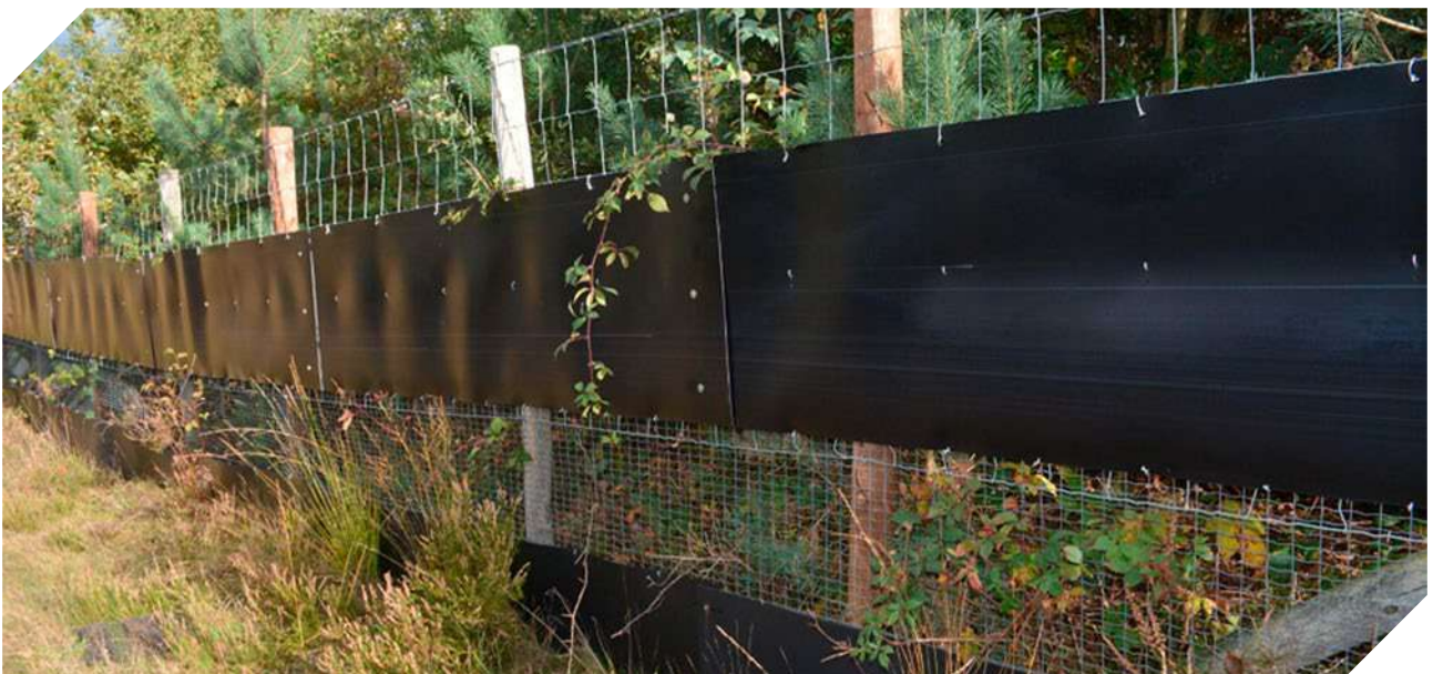
Figura 37. Uso de placa vinilica na porção inferior e intermediária de cercamento de fauna em rodovia da Holanda. © ViaFAUNA. Foto por Fernanda Abra.
