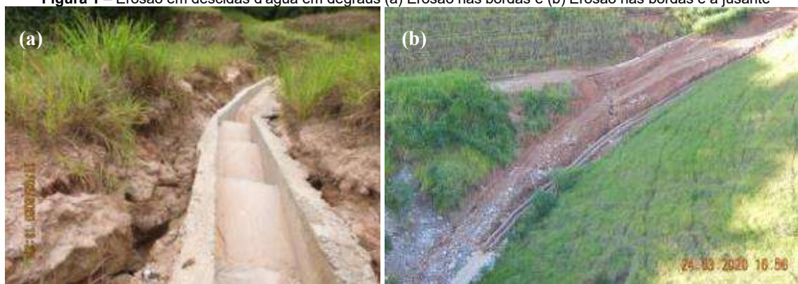
Figura 1 – Erosão em descidas d'água em degraus (a) Erosão nas bordas e (b) Erosão nas bordas e a jusante
