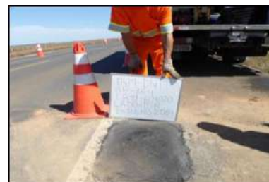
(d) Sondagem realizada
