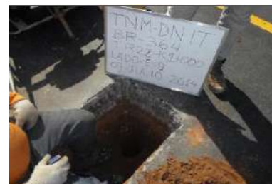
(d) Sondagem realizada
