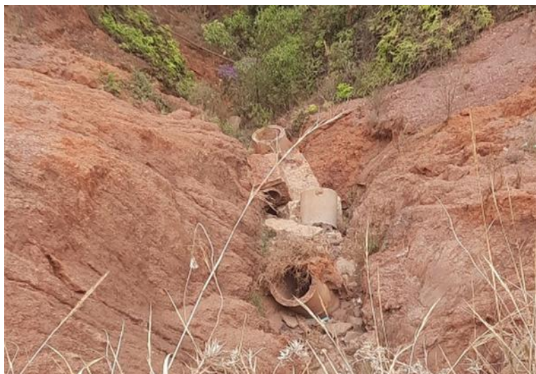
Figura 44 – Erosão avançada em talude de aterro e drenagem danificada
